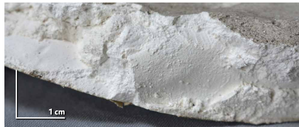
8.3.8. Detail narušené sádrové hmoty. Degradace prostupovala celou tloušťkou sádrového střeptu. (foto: P. Zítková)
