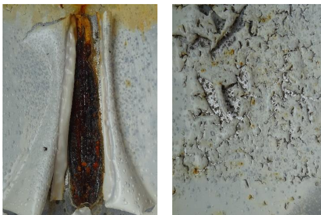
Obrázek 14 Ukázka delaminace z řezu (vlevo) a ztráty přilnavosti povlaku (vpravo)
