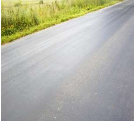
Ztráta makrotextury v celé šířce vozovky.
