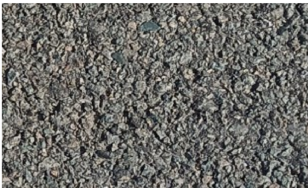
Obrázek 40: Úsek č1: Ztráta asfaltového tmelu [21]
