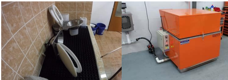
Obr. 17 Oplachové stanoviště a průmyslová myčka dílů pro dezinfekci vakuových toalet
