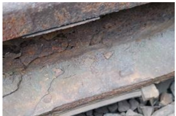
Obr. 1-9: Korozně napadená kolejnice – tunel v úseku Praha hl. n. – výhybna Vyšehrad
