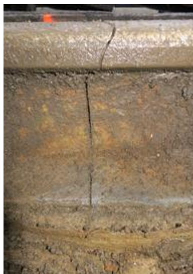
Obr. 1-2: Lom kolejnice – žst. Kolín
