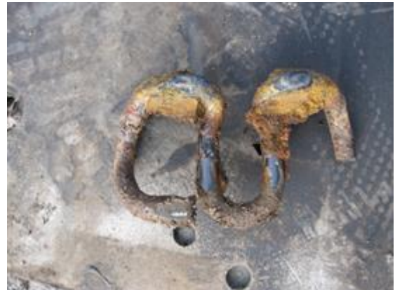
Obr. 1-18: Prasklá svěrka Skl14 vyjmutá z přejezdu v žst. Kolín
