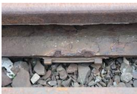
Obr. 1-11: Poškozená kolejnice – patrný otisk svěrek v patě kolejnice - tunel v úseku Praha hl. n. – výhybna Vyšehrad
