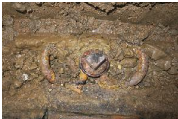
Obr. 1-1: Poškozená svěrka v železničním přejezdu (celopryžová konstrukce) – žst. Kolín
