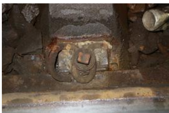
Obr. 1-10: Poškozená svěrka - tunel v úseku Praha hl. n. – výhybna Vyšehrad
