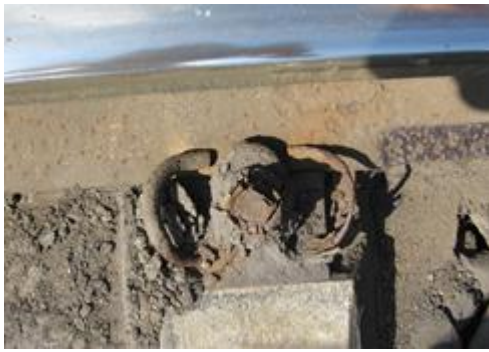
Obr. 1-6: Korozně napadená svěrka – celopryžový přejezd u Dobříně
