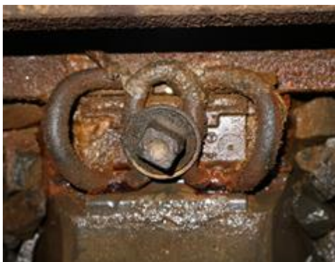
Obr. 1-8: Korozně napadená svěrka, patrná přítomnost vlhkosti - tunel v úseku Praha hl. n. – výhybna Vyšehrad
