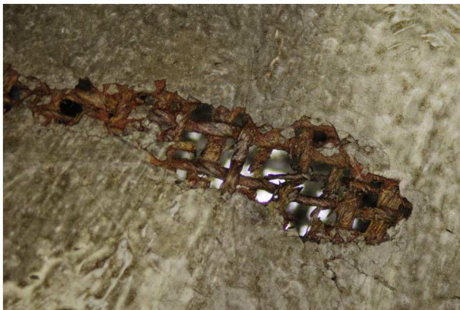
Obr. 76: Detail, chybějící barevná vrstva i s podkladem. 86
