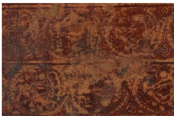
Obr. 209 Mechanické poškození (odření)
