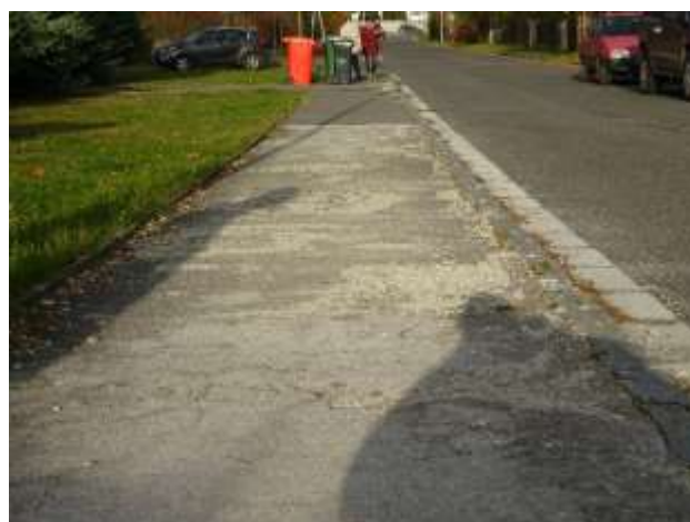
Obrázek 34 Pohled na poškozený chodník podle zdravotního střediska
