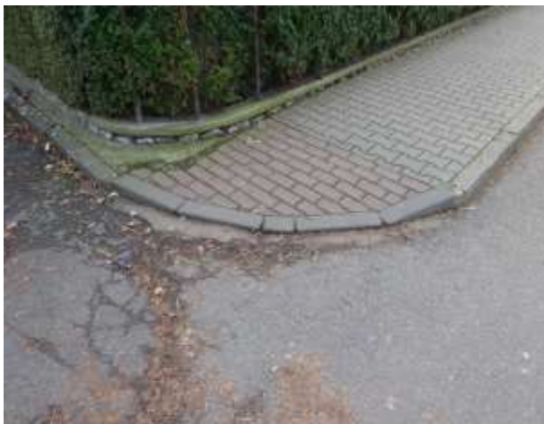
Obrázek 24 Nevhodně použitý varovný pás u místa pro přecházení – ulice Příčná
