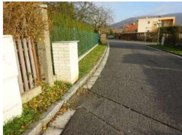
Obrázek 31 Nedostatečná šíře travního pásu pro vybudování chodníku
