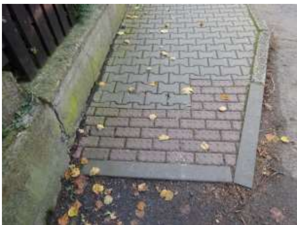
Obrázek 23 Nevhodně použitý varovný pás u místa pro přecházení Zdroj: autor
