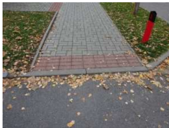
Obrázek 27 Navazující chodník ke škole – správně varovný pás, chybí signální pás Zdroj: autor
