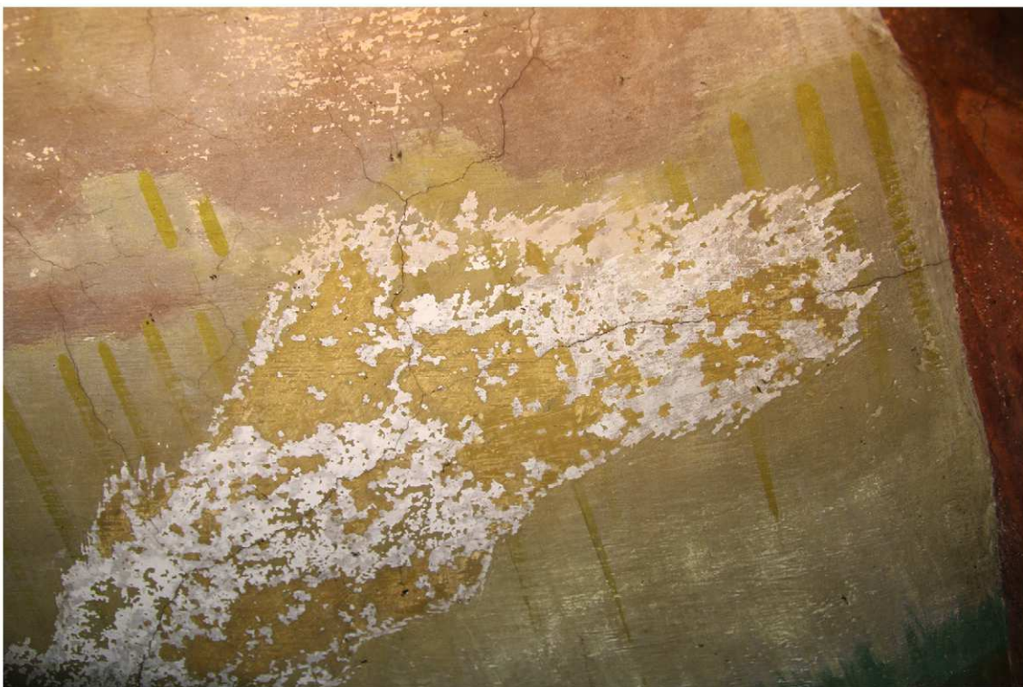
Stav přemalby na vybraných místech - detaily puchýřovatení a zpráškovatění. Nahoře - pod přemalbou prosvítá barokní malba. Dole - vyspráva trhliny se propisuje na povrch.
