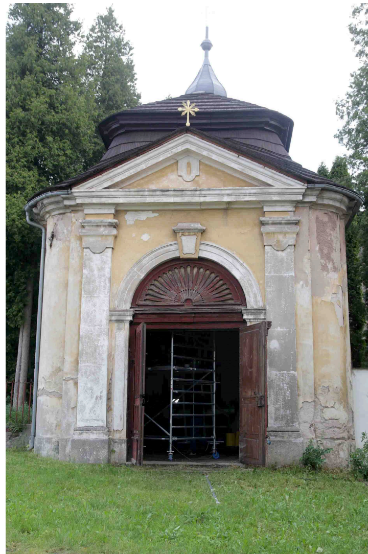
Obr. 12: Kaple Bolestné Panny Marie – exteriér. Stav před restaurováním.
