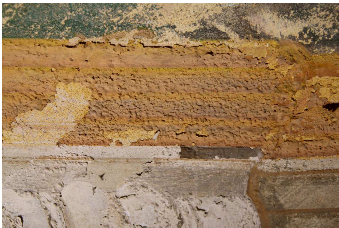
Obr. 41: Poškození puchýřkovatění vrstvy z 19. století v oblasti okrové římsy. Stav před restaurováním.
