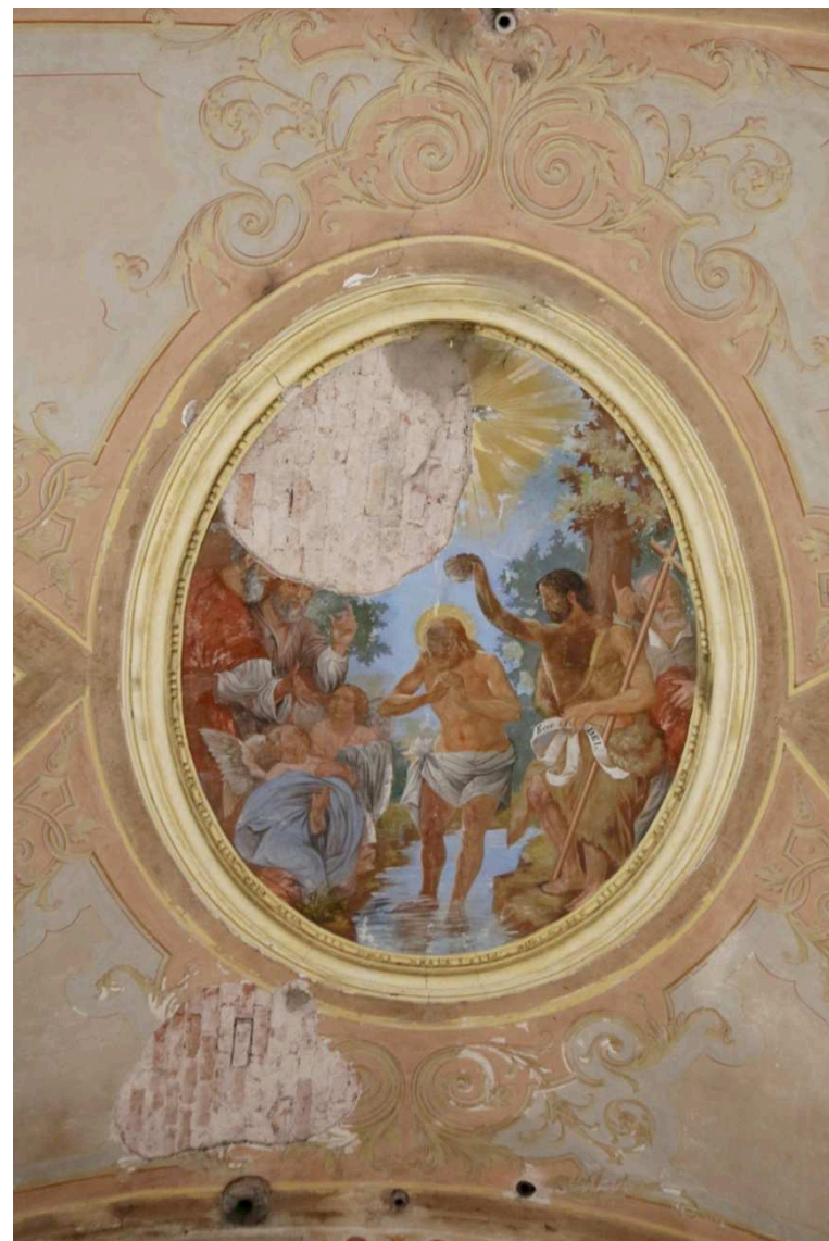
Obr. 107: Steinfelsovy fresky v klenbách kaple, které byly patrně zrestaurovány Adolfem Tinzmannem starším, či jeho synem při úpravě kostela v roce 1898. Na fotografii je patrný chátrající stav maleb
