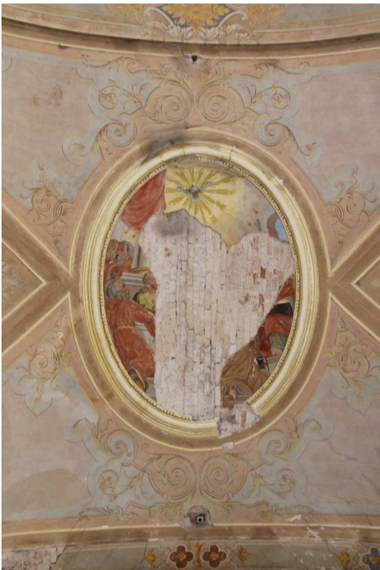
Obr. 106: Steinfelsovy fresky v klenbách kaple, které byly patrně zrestaurovány Adolfem Tinzmannem starším, či jeho synem při úpravě kostela v roce 1898. Na fotografii je patrný chátrající stav maleb.
