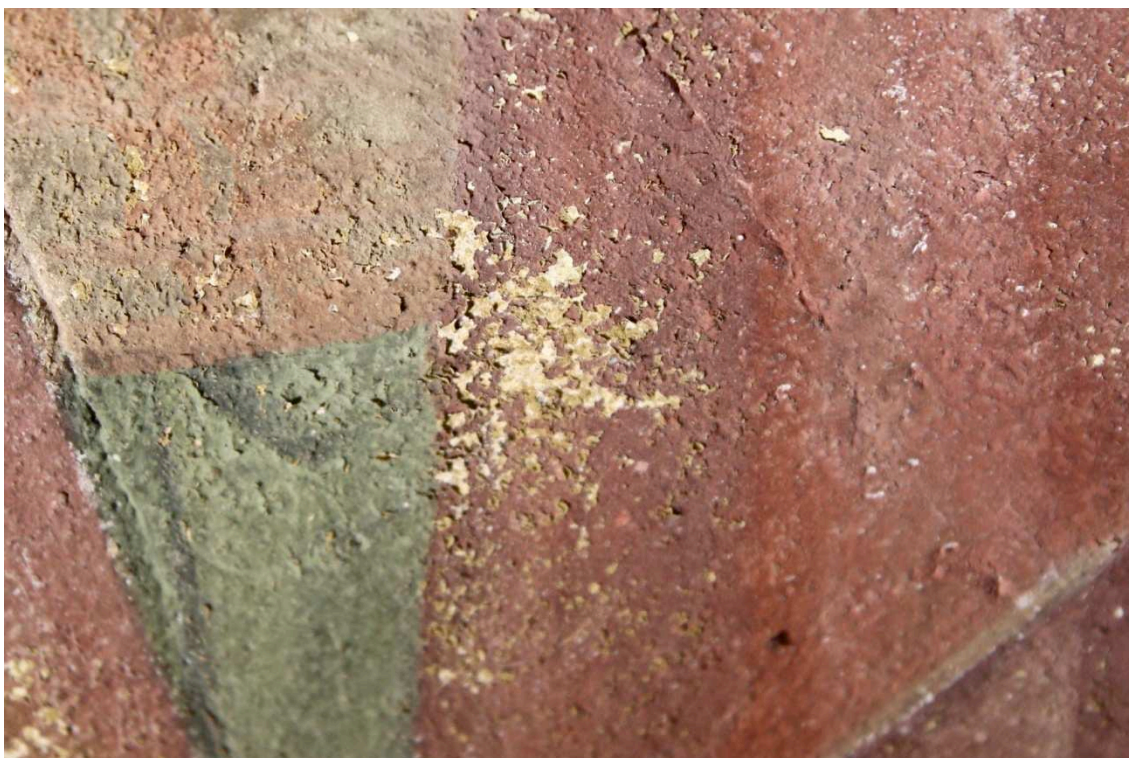
Obr. 36: Na fotografii je pozorováno poškození zpráškovatěné barevné vrstvy z 19. století. Detailní popis poškození a jeho příčiny jsou uvedeny v kapitole 3.2.1 Vizuální průzkum v rozptýleném denním světle . Stav před restaurováním.
