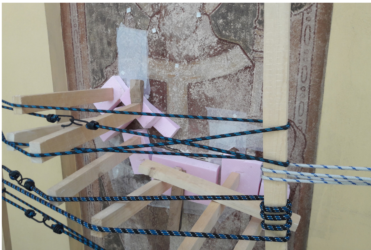
Obr. 32: Tlakovacie zariadenie na zosilnenie účinku injektážnej malty a čiastočné vyrovnanie zvlneného povrchu omietky
