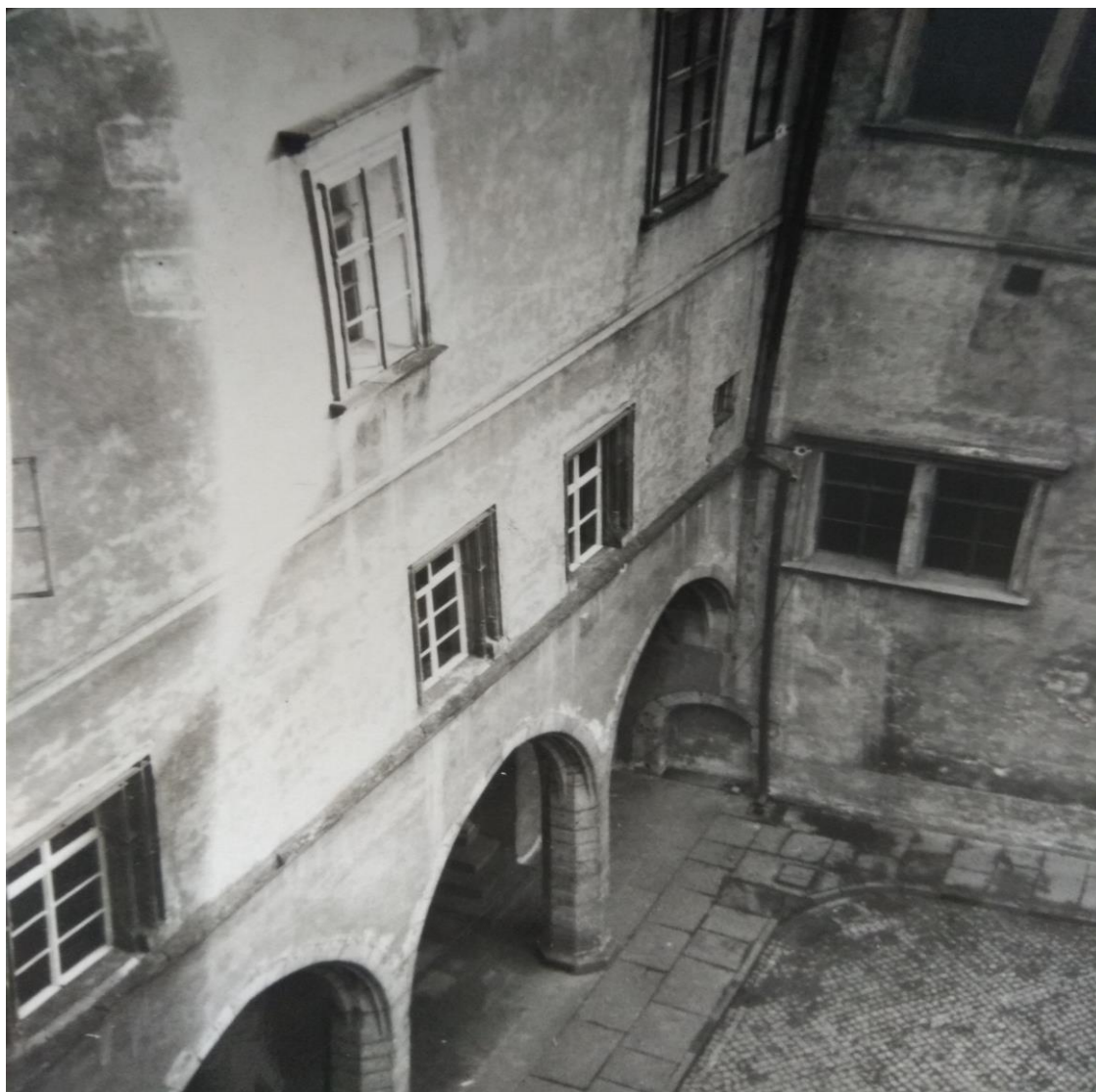
Příloha č. 2. Pardubický zámek – Pohled z vikýře v krovu do jihovýchodního rohu nádvoří. Foto Vladimír Uher, SURPMO, 1958. NPÚ ÚOP Pardubice, Odbor EDIS – odborná spisovna, fond plánové dokumentace.
