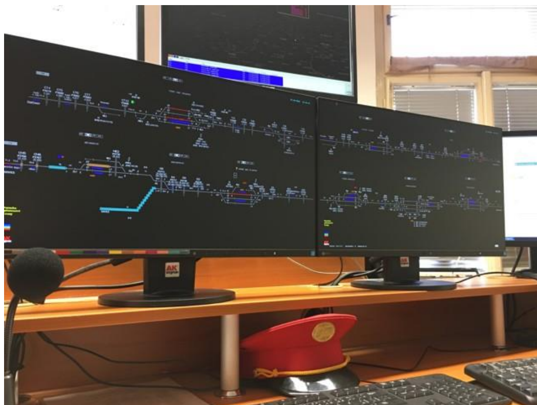
Obrázek č. 6 – Pracoviště traťového dispečera DOZ Vrané nad Vltavou
