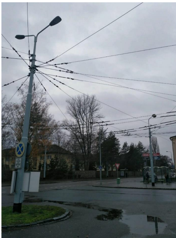
Obrázek 7 Normální výška trolejového vedení
