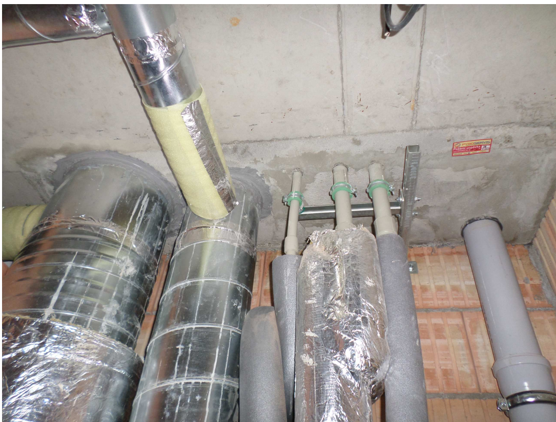
Obrázek 19: Stoupačí potrubí s požární ucpávkou
