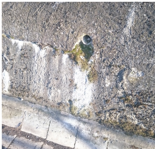
Obr. 24 - Poruchy odvodnění zárubní zdi [1]
