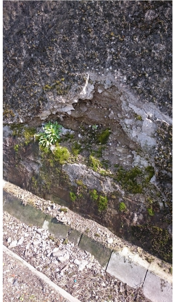
Obr. 24 - Porucha zárubní zdi [1]
