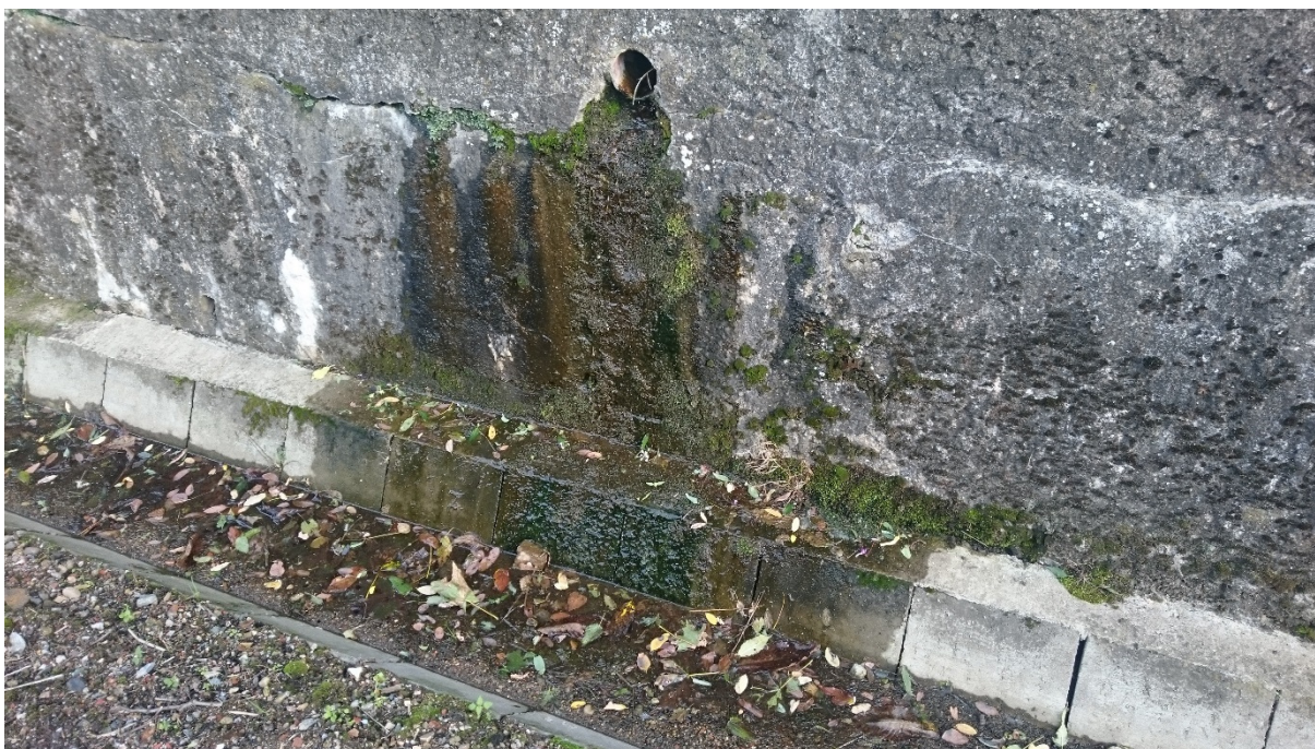
Obr. 21 - Poruchy odvodnění zárubní zdi [1]
