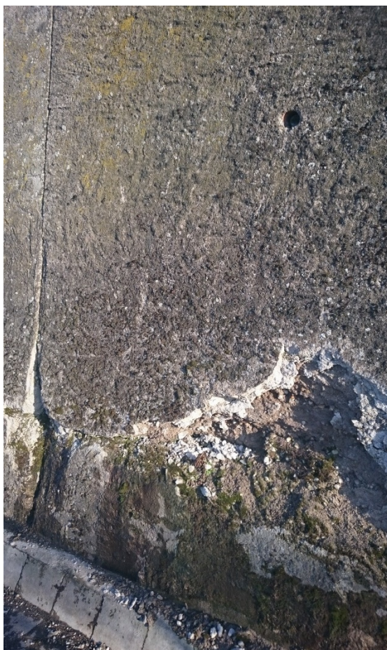
Obr. 25 - Poruchy zárubní zdi [1]
