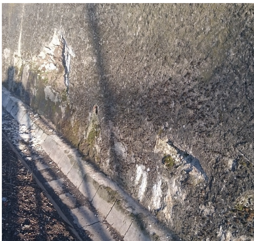
Obr. 22 - Poruchy zárubní zdi [1]
