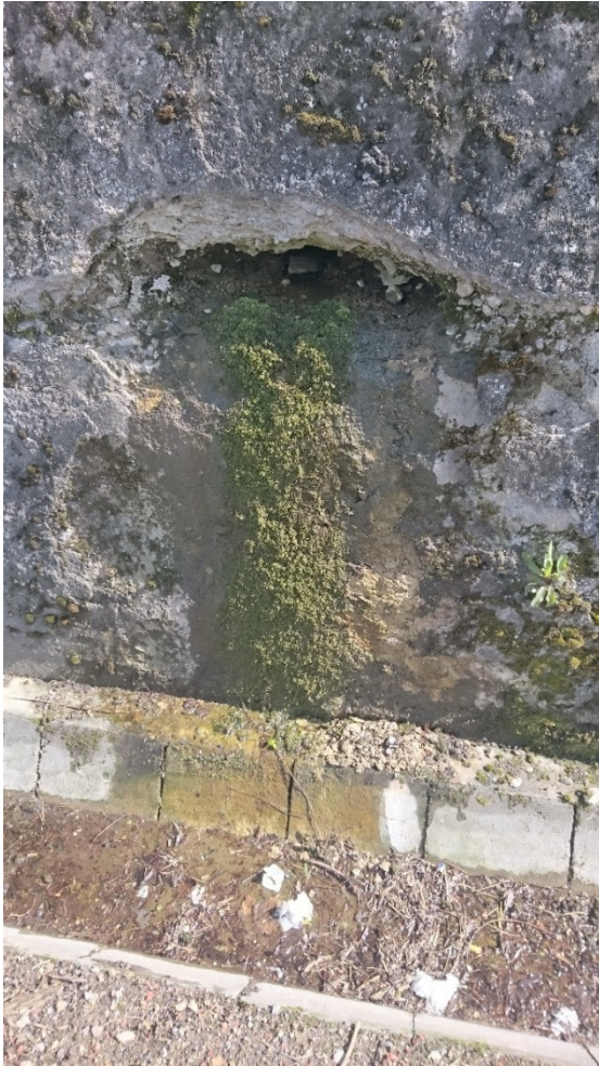
Obr. 23 - Porucha zárubní zdi [1]
