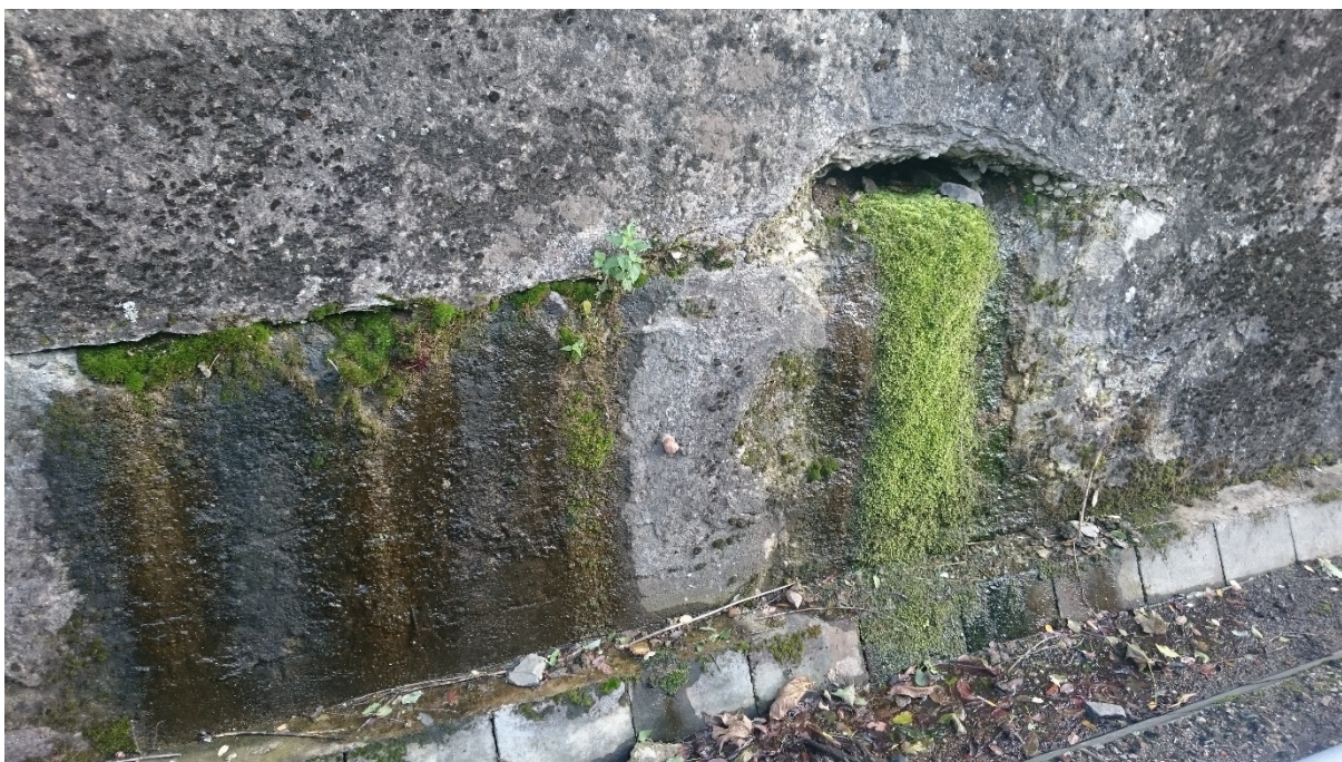
Obr. 20 - Poruchy odvodnění zárubní zdi [1]
