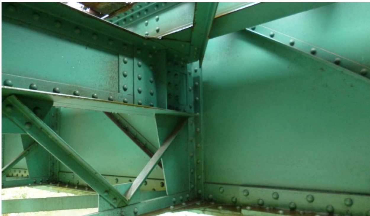
Obrázek 6 – Příčník, podélník (plátování), zavětrování stěny, vyztužení hlavního nosníku, mostnice, ztužení podélníku, zavětrování hlavního nosníku
