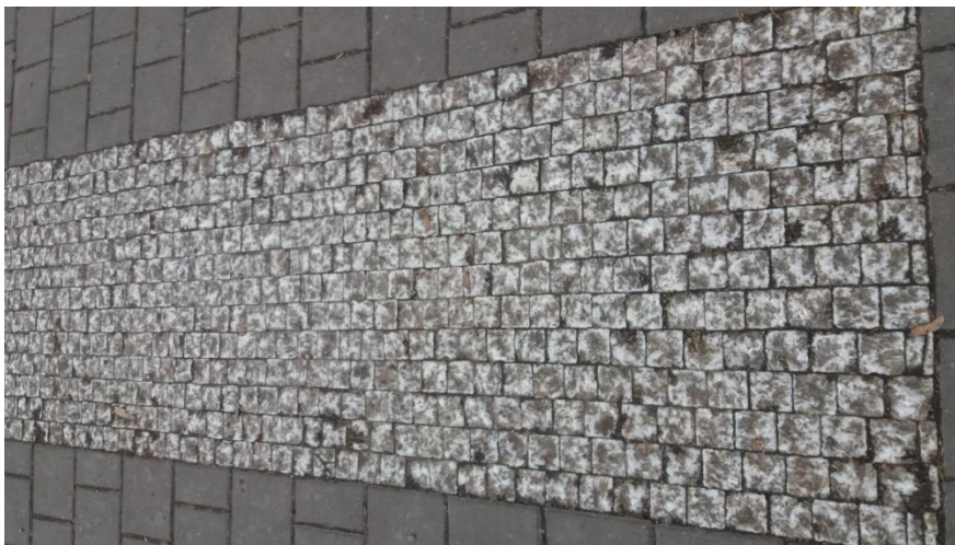
Obr. 1 Nevhodně zvolený materiál signálního a varovného pásu
