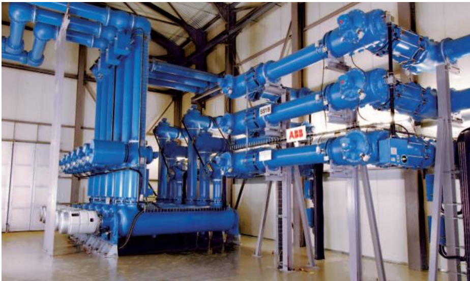
Obrázek 7 Rozvodna velmi vysokého napětí (ABB, 2011)
