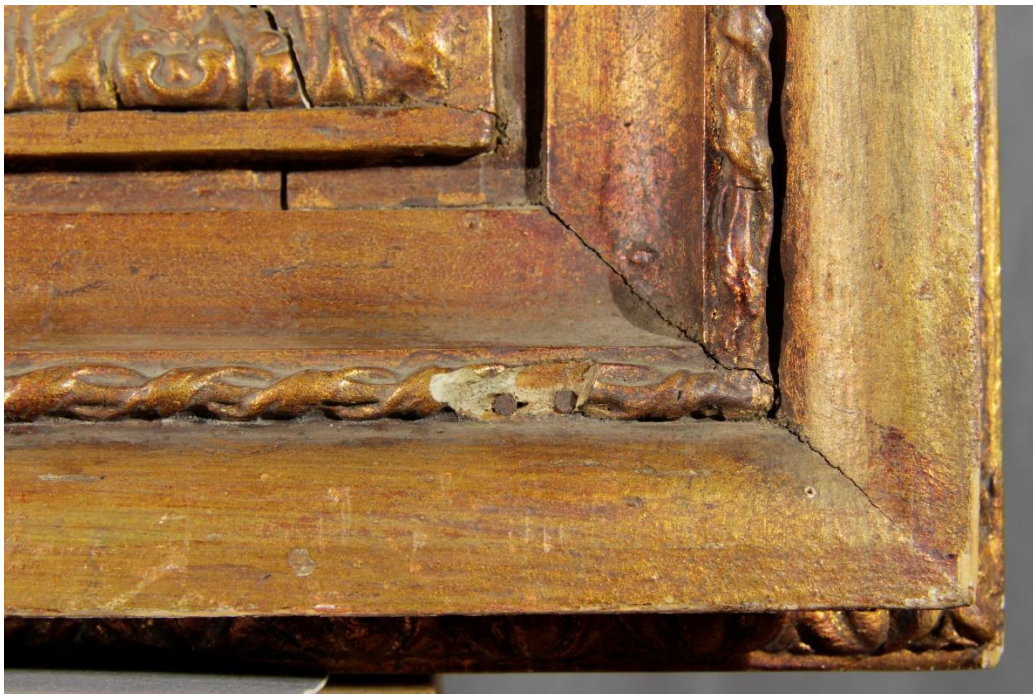
Obr. 4: Stav před restaurováním, pravý dolní roh, detail poškození rámu, ztráta plastického dekoru, prachový depozit
