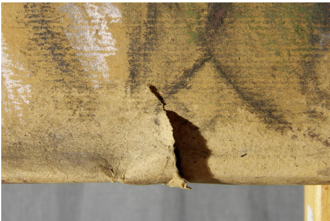
Obr. 7: Stav před restaurováním, detail trhliny (spodní okraj díla)
