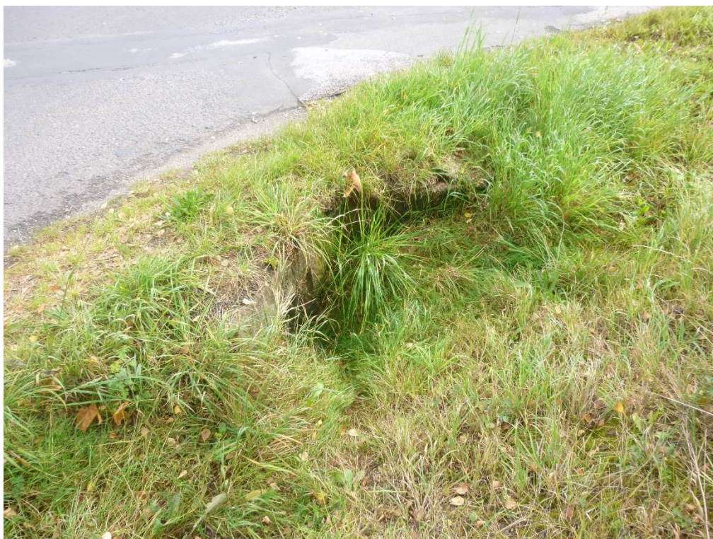
Obr. 17 – Pohled na nefunkční vtokový objekt při křížení ul. Žižkova a K Břízkám
