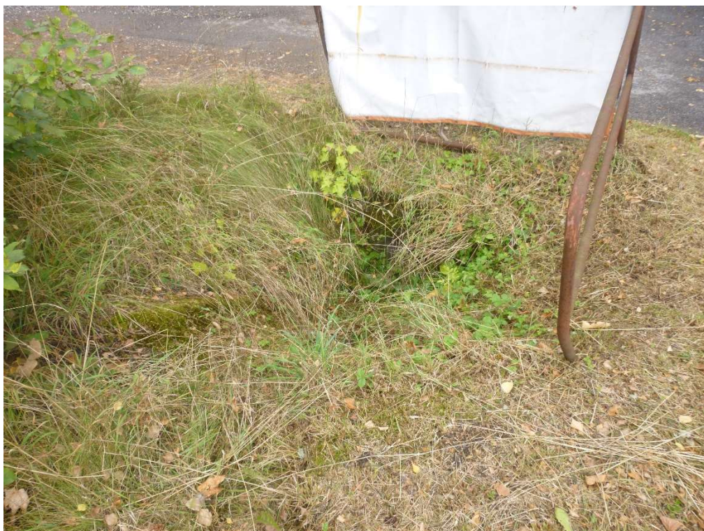
Obr. 18 – Pohled na nefunkční výtokový objekt při křížení ul. Žižkova a K Břízkám
