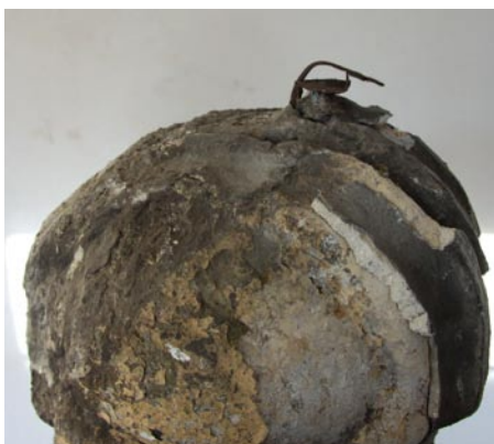
Obr. 2 - Ohnutý a zkorodovaný křížek na vrchu koruny
