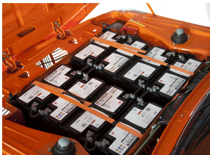
Obr. 1.10 Těžké olověné akumulátory pod kapotou prvního elektromobilu BMW 1602 [33]
