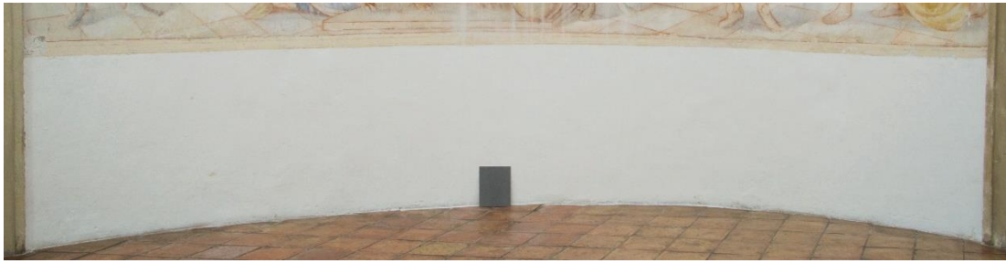
Obr. 85. Soklová část pod restaurovaným výjevem ve stavu před restaurováním.
