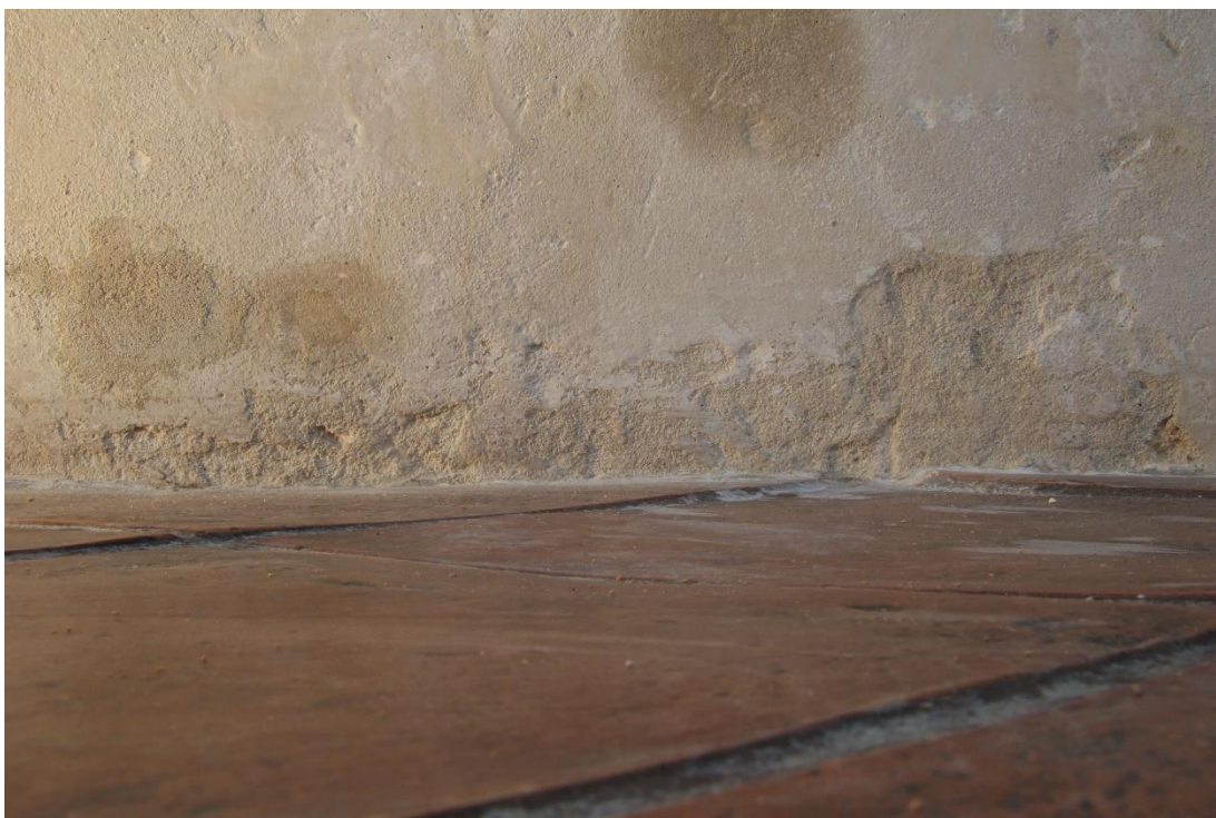
Obr. 79. Detail v bočním světle po odstranění sádrového tmelu u podlahy.
