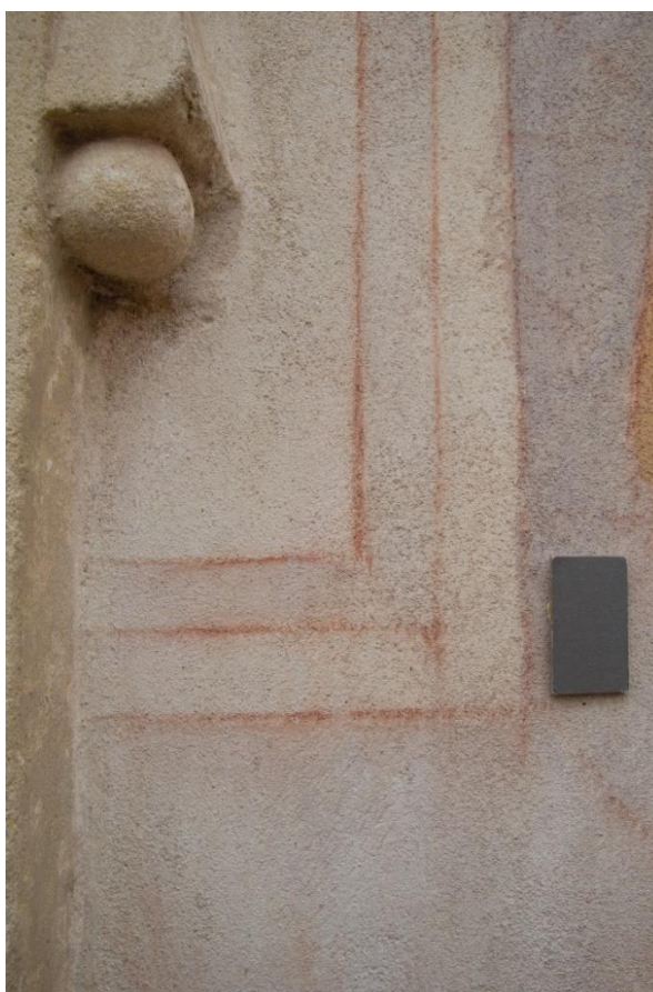
Obr. 54. Statická trhlinka u kamenného ostění dveří byla vyplněna tmelem a retušována.
