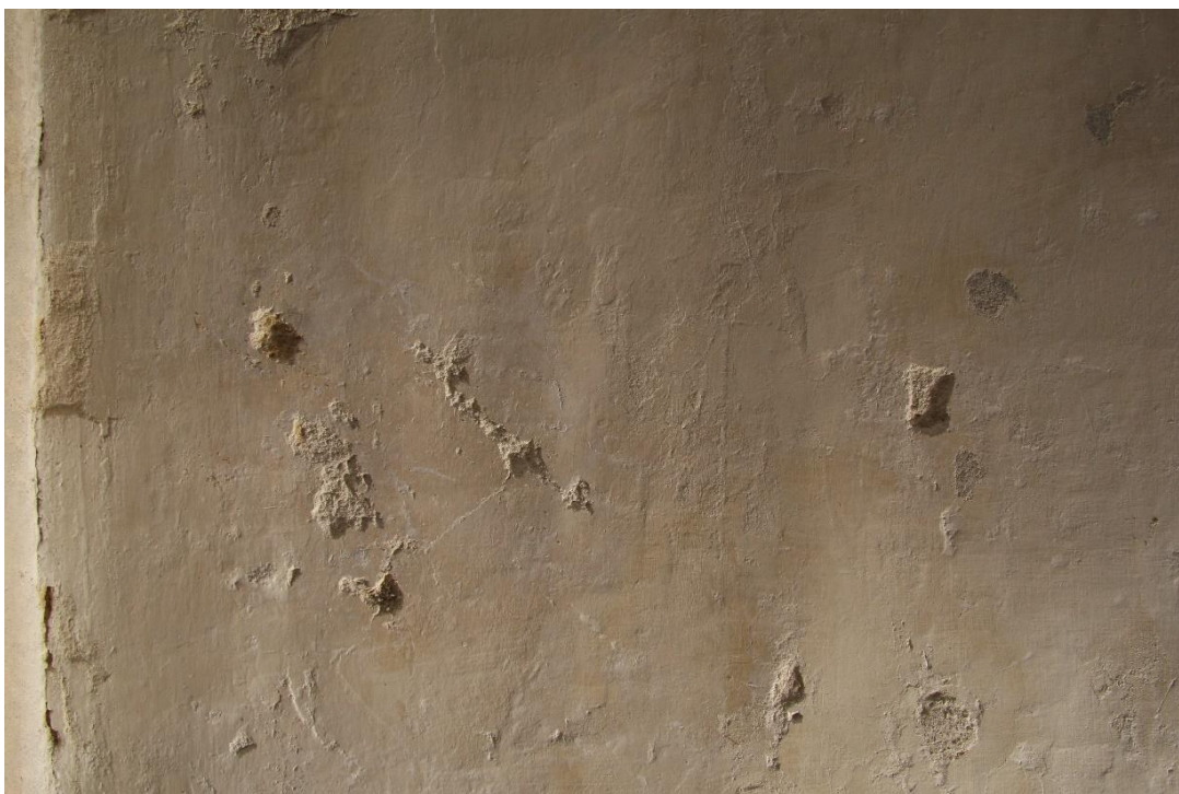
Obr. 77. Levá soklová část v bočním světle po odkryvu bílého hlinkového nátěru na historický štuk. Nevyhovující tmely byly odstraněny.
