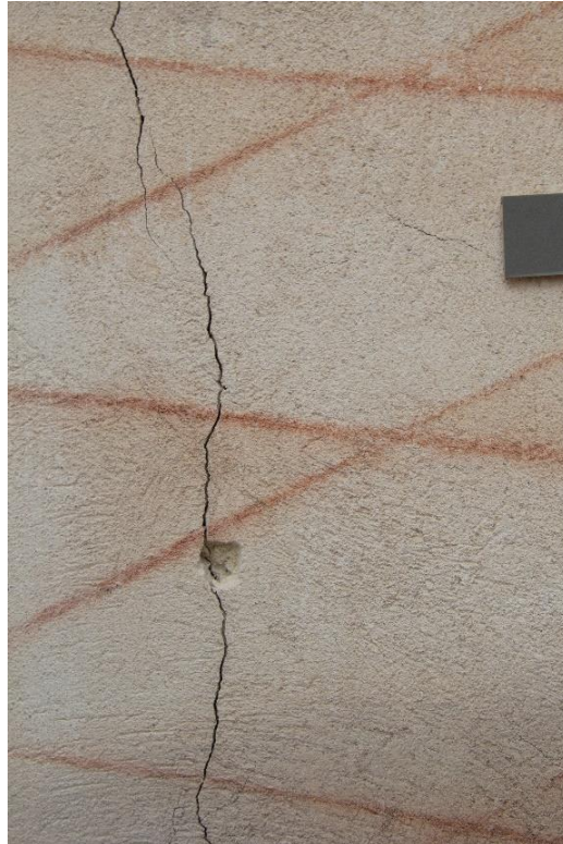
Obr. 55. Detail svislé statické trhliny u středu výjevu. Malá čtvercová sonda byla provedena při průzkumu v roce 2013.
