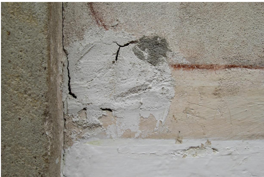
Obr. 83. Hloubková sonda 1JZ 84 byla zakryta nevhodným tmelem, který praskal. Sonda byla v rámci současného sondážního průzkumu znovu odkryta.
