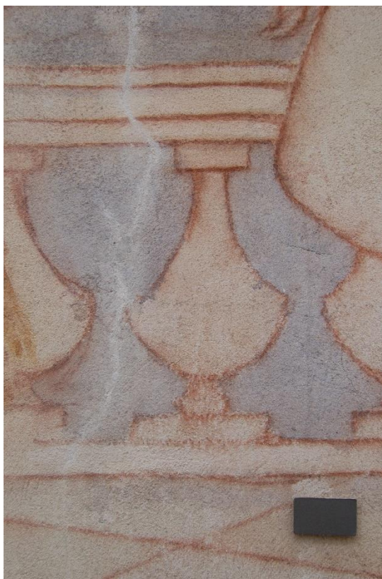
Obr. 57. Svislá statická trhлина u středu výjevu po vytmelení. Našedlá barevnost tmelu se střelečským pískem byla vhodná k následným retuším.
