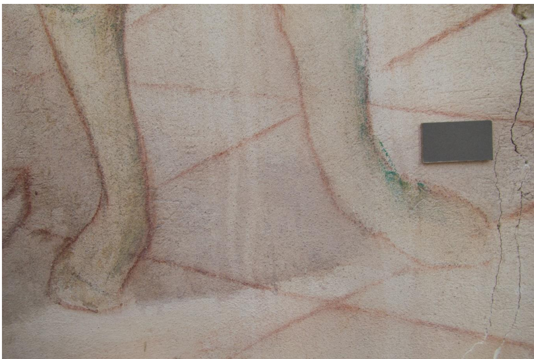
Obr. 61. Detail bot postavy mladíka, který drží v rukou listiny. Jedná se o stav malby po vyčištění povrchu výjevu latexovou houbou Akapad. Vpravo se nachází část vertikální statické trhliny.
