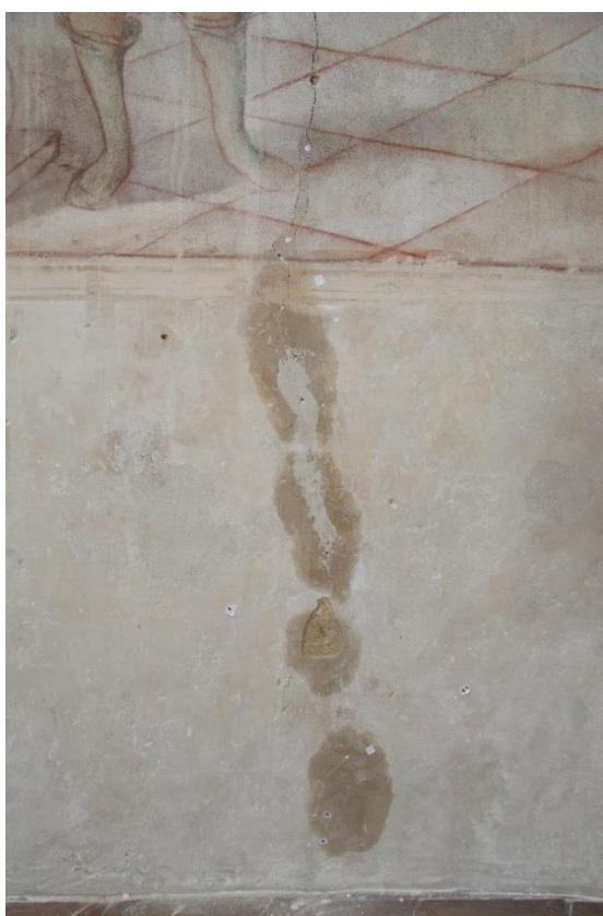
Obr. 74. Po odkryvu soklu na vrstvu historického štuky se ukázalo, že statická trhлина u středu výjevu pokračuje zdí téměř k podlaze síně. Na mnoha místech jí bylo třeba zpevnit injektáží. Sádrová vysprávka na trhlíně byla odstraněna.
