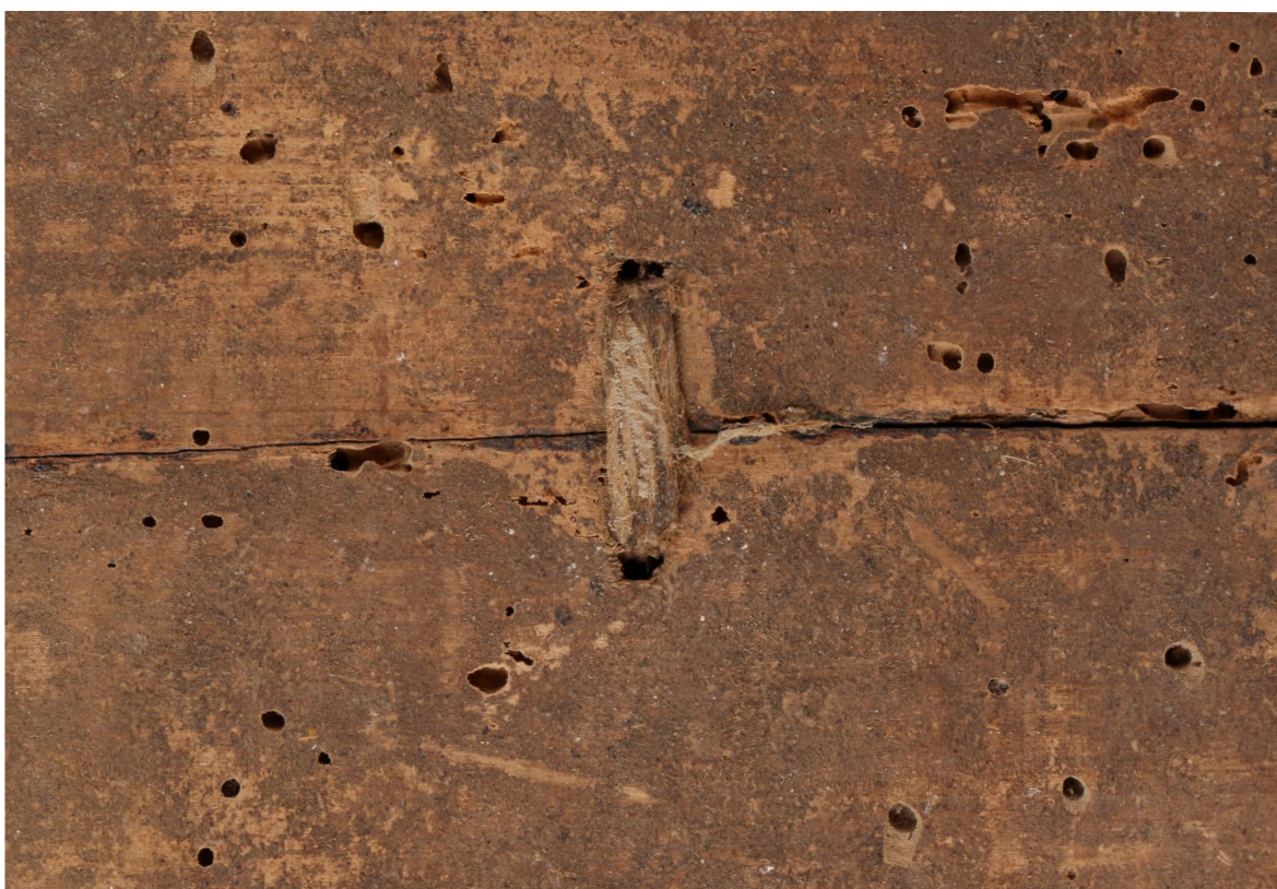
fotografia č. 38 – Detail dobovej opravy praskliny v knižnej doske
