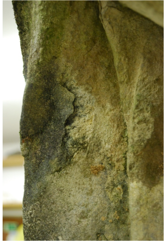
Obr. č. 8 – Oddělovací se vrstva tmelu a koroze povrchu kamene
