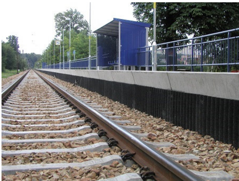
Obrázek č. 34 – nástupištní hrana H130 s hlukově pohltivými tvárniciemi v zast. Šťáhlavy (zdroj: ŽPSV a.s.)
