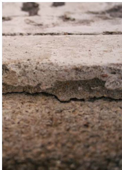
Obr. 235 Výjev 16. Omítka tmelu se odděluje od kamenného ostění.
