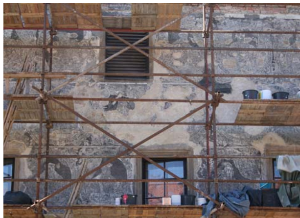
Obr. 239 Medailón 5 a 16. Stav po odstranění nátěrů a tmelů.
