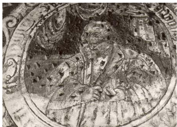
Obr. 203 Detail medailónu, dům č.p. 453, foto z pol. 20.století. Pekovaná horní část medailónu je původní. Je zde patrná i původní technika stínovaného sgrafita.
