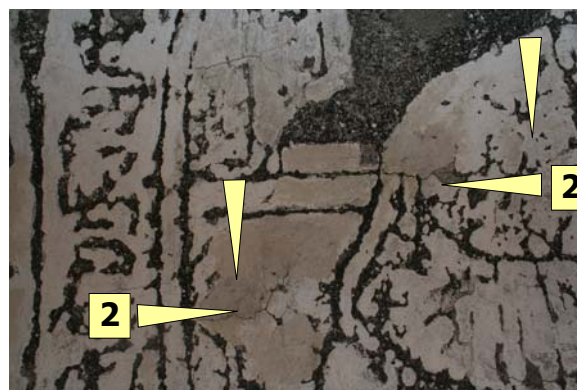
Obr. 230 Výjev 5. Prořezaný otvor na injektáž z opravy v roce 1997 zatmelený a zaretušovaný ztmavlým bílým nátěrem 6, pod ním vypraskaná boule (2).
