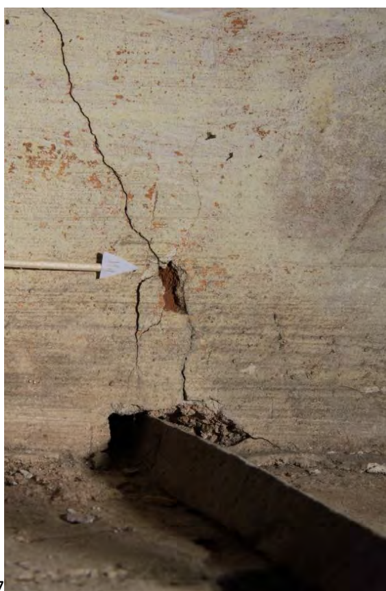
Obr. 139 Část iluzivního pásu mraků mezi výjevy Cherubim a Seraphim, defekt, vzorek M1.
