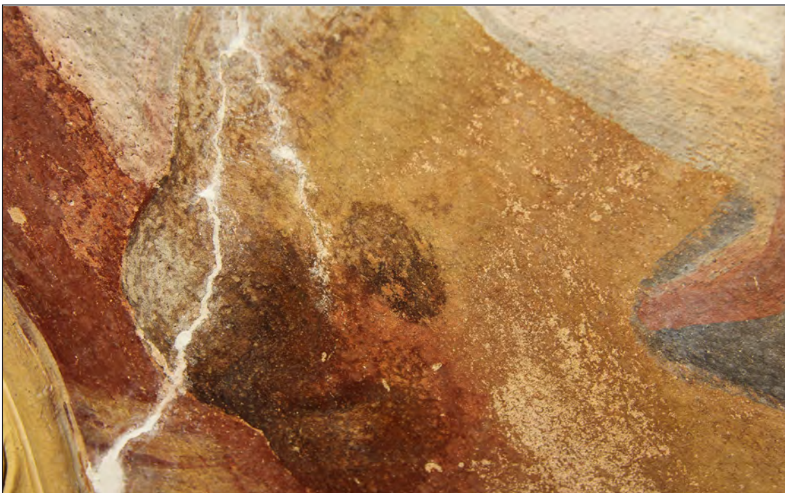
Obr. 28. Seraphim (detail), stav v průběhu restaurování, tmelení chybějící omítkové vrstvy a prasklin.
