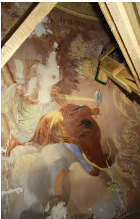
Obr. 122 Defekt v levé dolní části výjevu Cherubim, vzorek O2.
