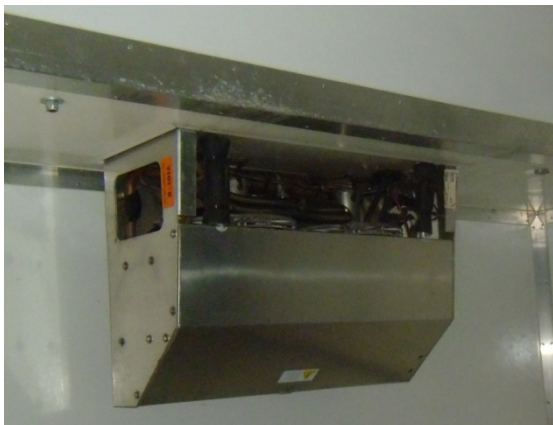
Obrázek 7 Klimatizace Zdroj: autorka
