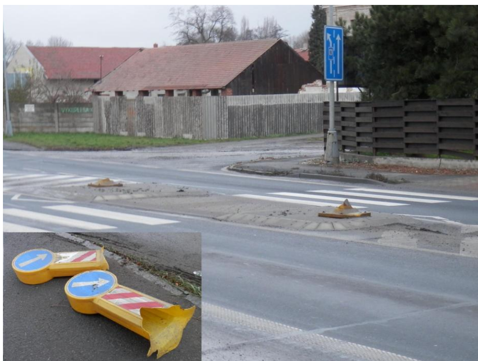
Obrázek 14 Poškozený přechod pro chodce v Litomyšli
