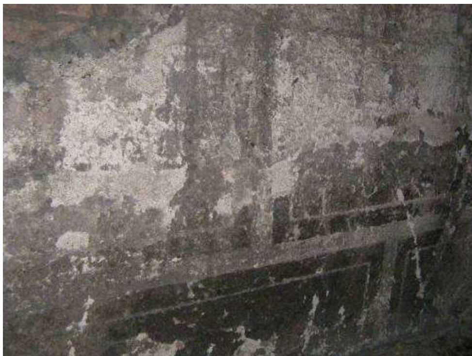
Obrázek 55 Reliéf Renesanční sgrafito na púdě nad reliéfem – patrné stopy po zatékání (foto: Ing. Petr Justa)
