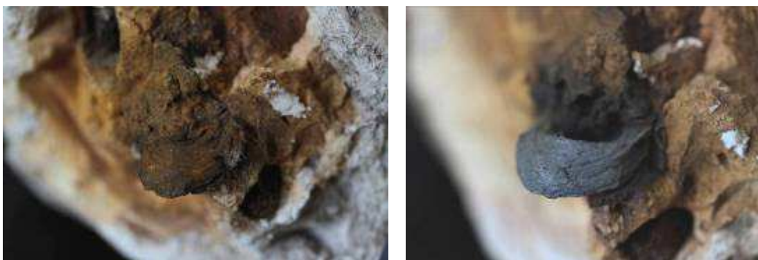
Obrázek 33 Madona Ošetření kovového čepu – stav před (vlevo) a po otryskání a ošetření povrchu inhibítorem koroze
