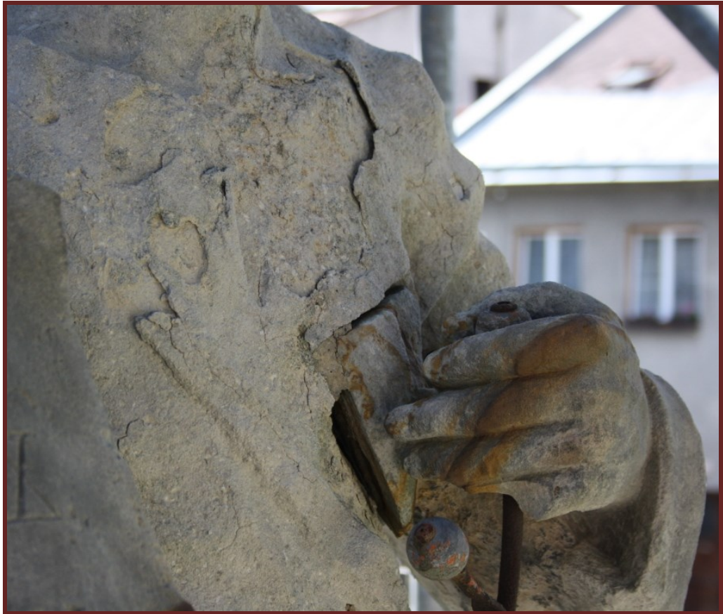
Obrázek 24: Horní část figury – po očištění: poškození, degradace horniny.
