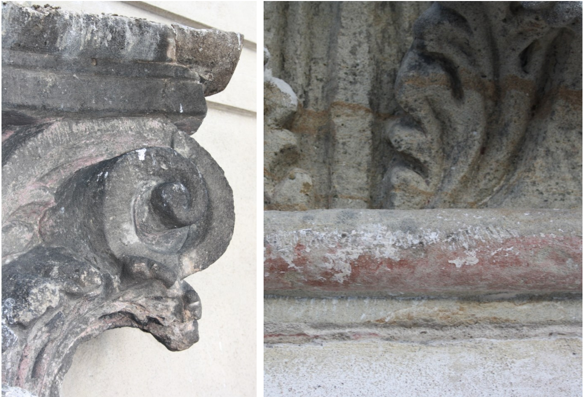
Obrázek 51: Detailní pohled na hlavice pilastrů, kde jsou zřejmé fragmenty původního červeného nátěru (foto: Müllerová M.) 56
