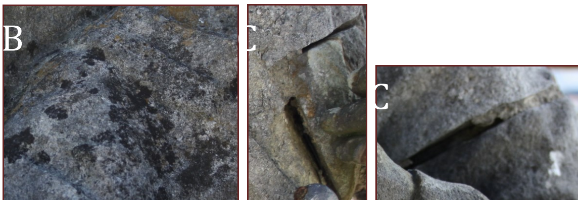
Obrázek 17: Detaily poškození: B – biologické poškození mechy a lišejníků, C – vyžilé tmely.
