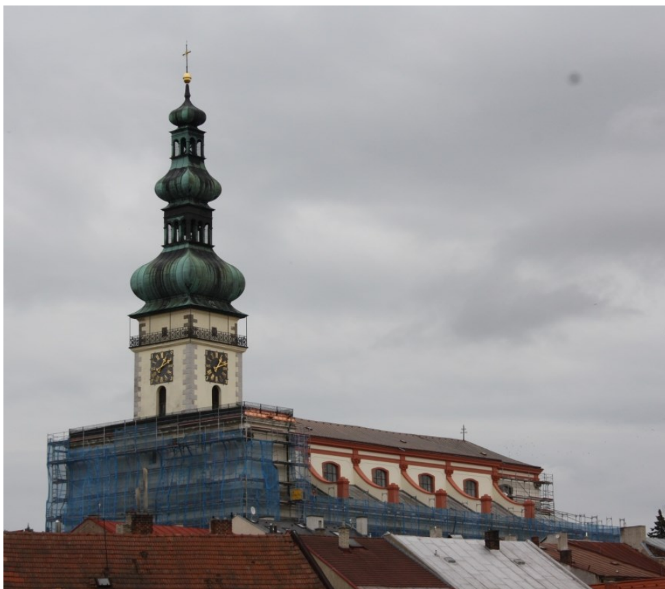
Obrázek 48: Pohled z dálky na kostel Nanebevzetí Panny Marie jako dominantu města v průběhu rekonstrukce v roce 2011; jižní strana po dokončení prací - obnovení původní barevnosti, podstavce pro osazení soch nad střechou boční lodi (foto: Müllerová M.)
