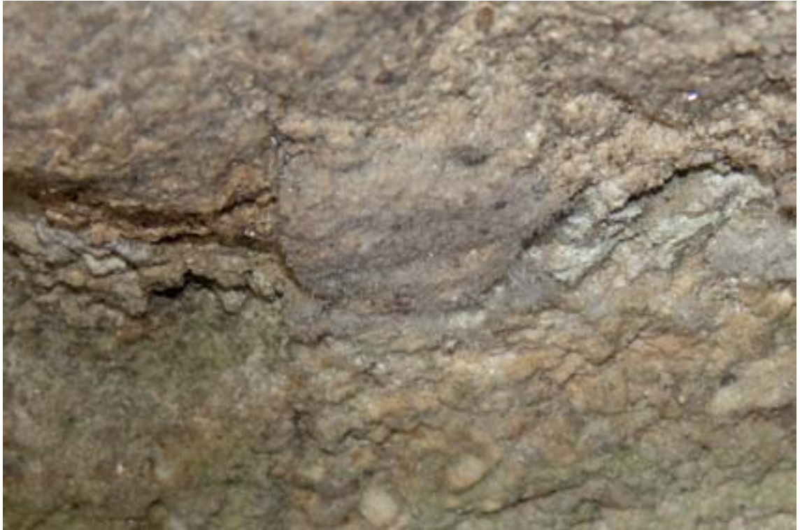
Obr. 22: Odhalená struktura omítky s výkvěty solí ve spodní partii stěny. Krystaly solí jsou jehličkovitého tvaru, detail. Stav před restaurováním.
