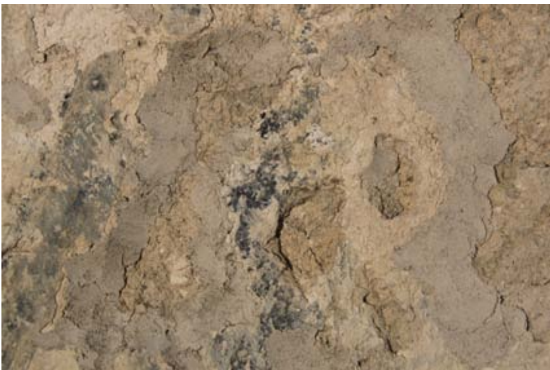
Obr. 20: Hrany intonaca a barevné vrstvy fixované Toroňem r. 1976, detail. Stav před restaurováním.
