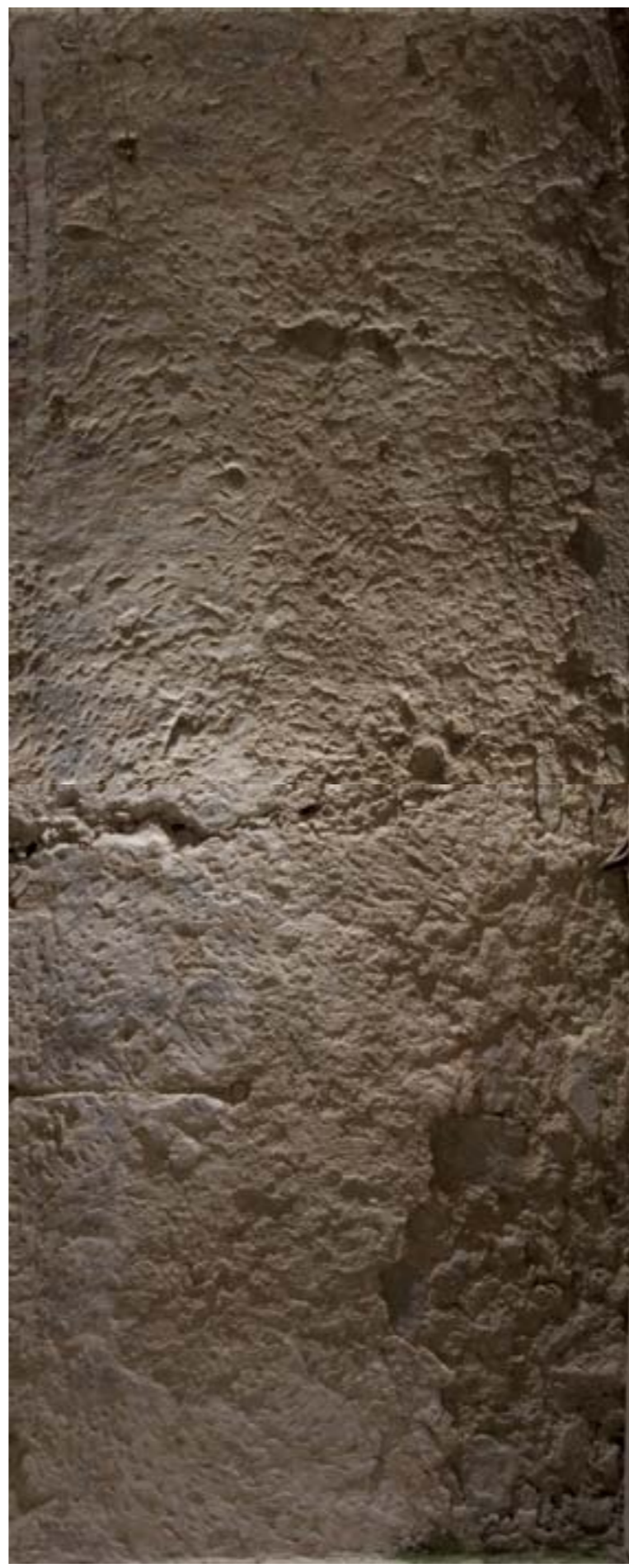
Obr. 8: Spodní figurální pás, celkový pohled. Velké úbytky omítky a malby vlivem hustého pekování a vzlínající vlhkosti, dále vertikální statická trhлина (uprostřed) a místo vedení bývalé elektroinstalace. Stav před restaurováním. Foto v bočním razantním nasvícení.
