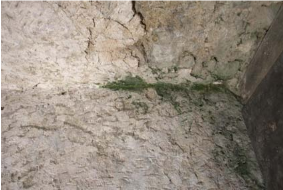
Obr. 26: Biologické napadení řasou a plísněmi, vlivem vzli- nející vlhkosti a zasolení dochází k velkým ztrátám omítky. Severovýchodní roh presbytáře, detail.
