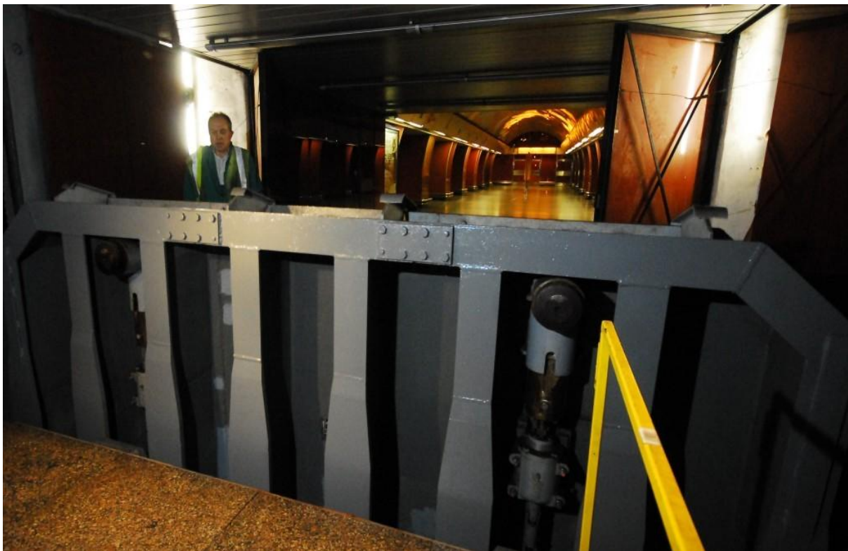
Obrázek 8: Tlaková vrata ve stanici metra Křižíkova
