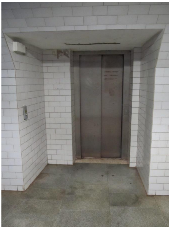
Obrázek 44 Osobní výtah č. 157 – stanice Hloubětín
