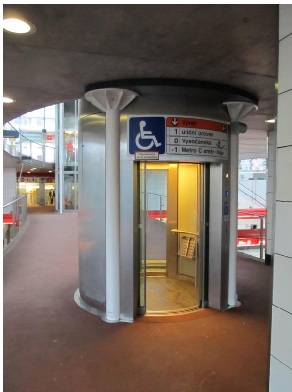
Obrázek 68 Osobní výtah č. 412 – stanice Střížkov
