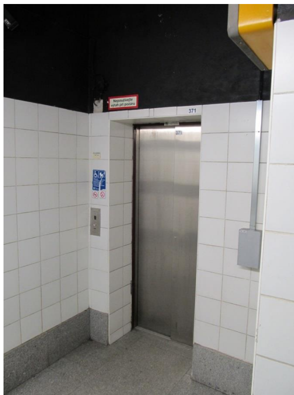
Obrázek 31 Osobní výtah č. 371 – stanice Lužiny
