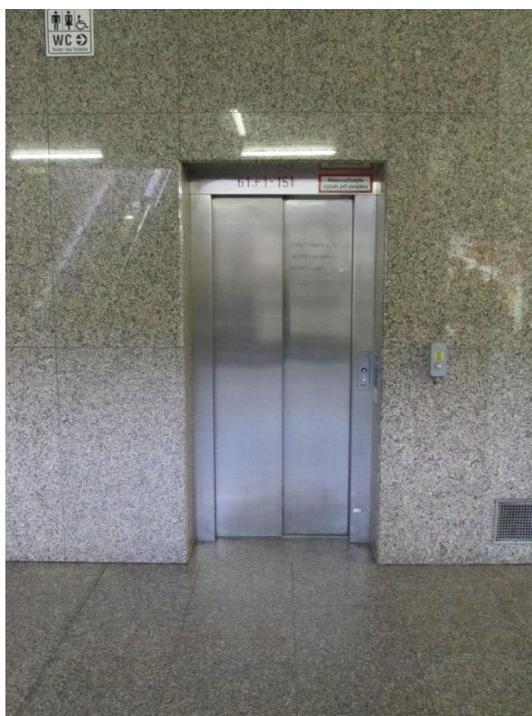
Obrázek 41 Osobní výtah č. 151 – stanice Vysočanská
