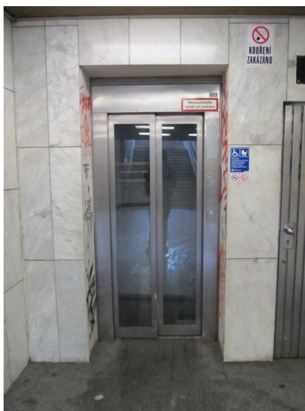
Obrázek 23 Osobní výtah č. 053 – stanice Dejvická
