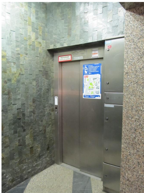
Obrázek 60 Osobní výtah č. 346 – stanice Florenc C
