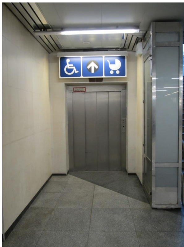
Obrázek 78 Osobní výtah č. 440 – stanice Letňany
