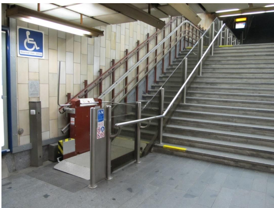
Obrázek 35 Plošina č. 334 – stanice Smíchovské nádraží
