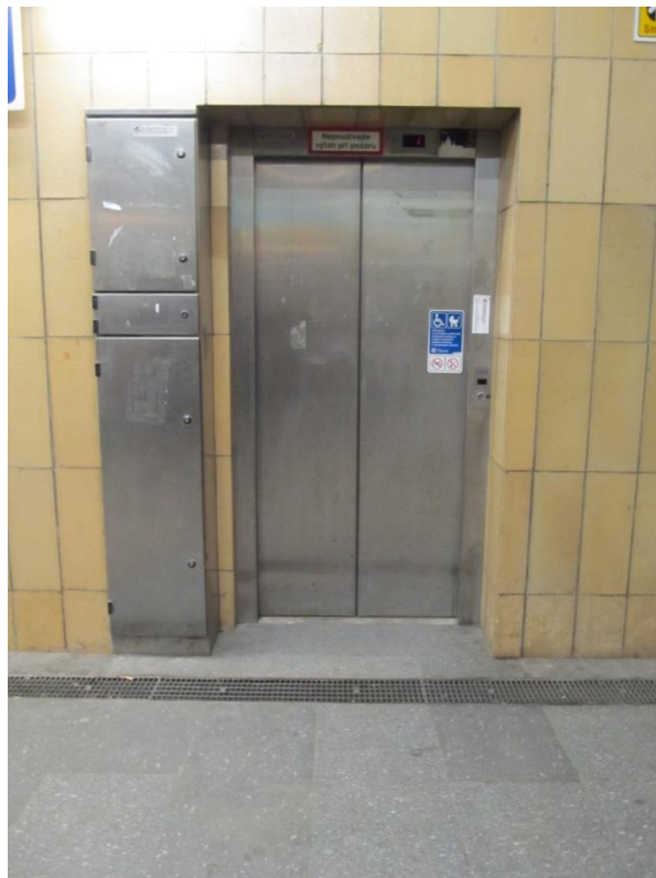
Obrázek 51 Osobní výtah č. 403 – stanice Chodov
