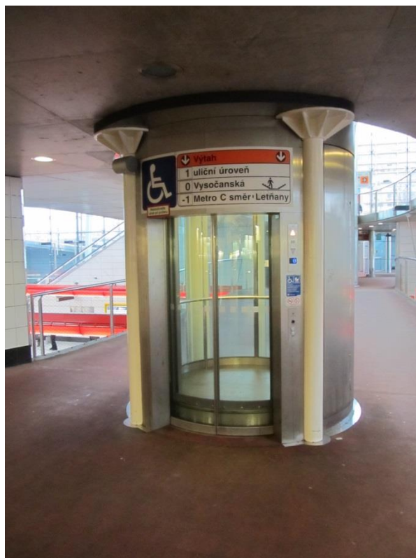
Obrázek 67 Osobní výtah č. 411 – stanice Střížkov
