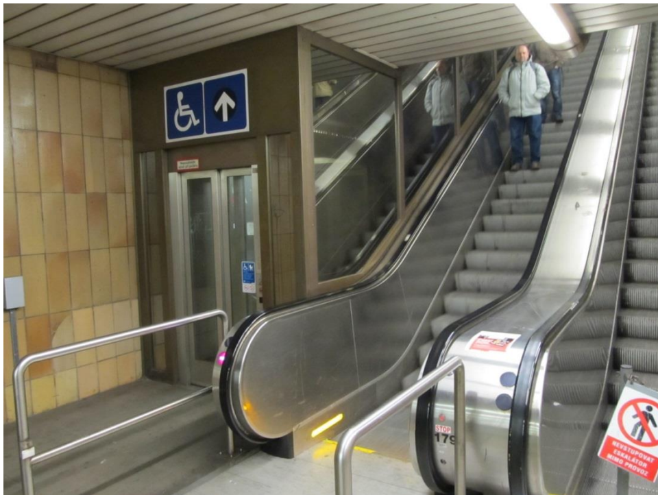
Obrázek 63 Osobní výtah č. 400 – stanice Vltavská
