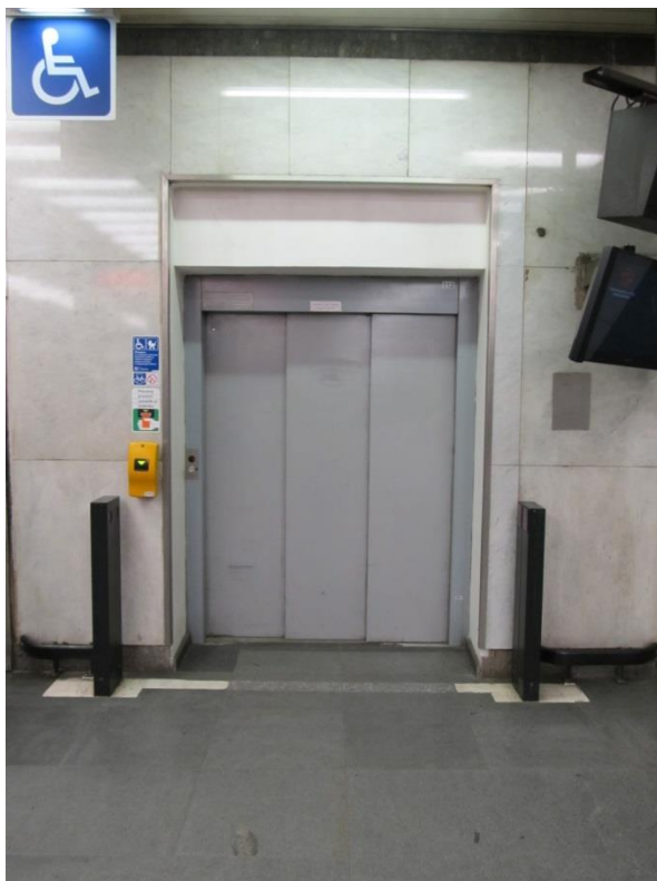
Obrázek 56 Osobní výtah č. 012 – stanice Pankrác
