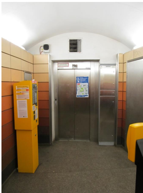
Obrázek 38 Osobní výtah č. 405 – stanice Florenc B
