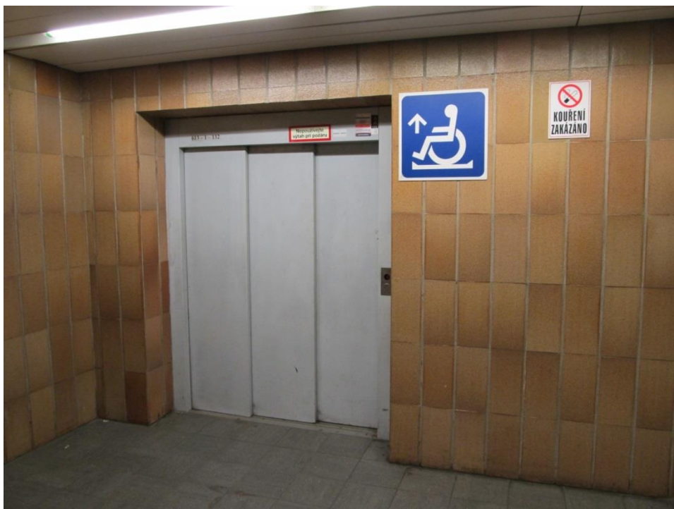
Obrázek 52 Osobní výtah č. 132 – stanice Chodov
