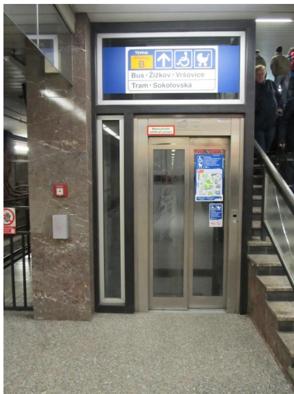
Obrázek 61 Osobní výtah č. 347 – stanice Florenc C
