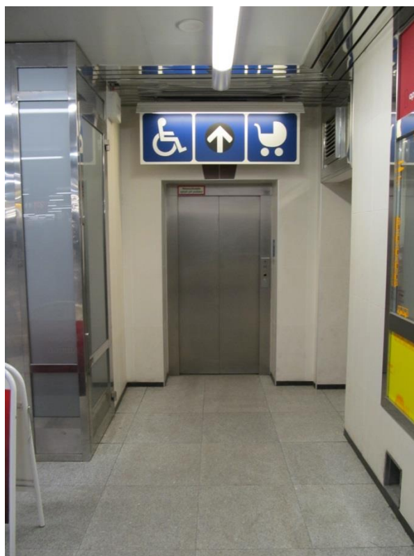
Obrázek 77 Osobní výtah č. 439 – stanice Letňany
