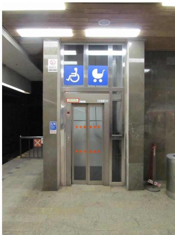
Obrázek 24 Osobní výtah č. 052 – stanice Dejvická
