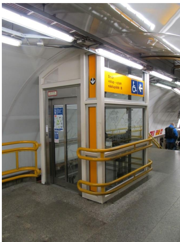
Obrázek 39 Osobní výtah č. 404 – stanice Florenc B
