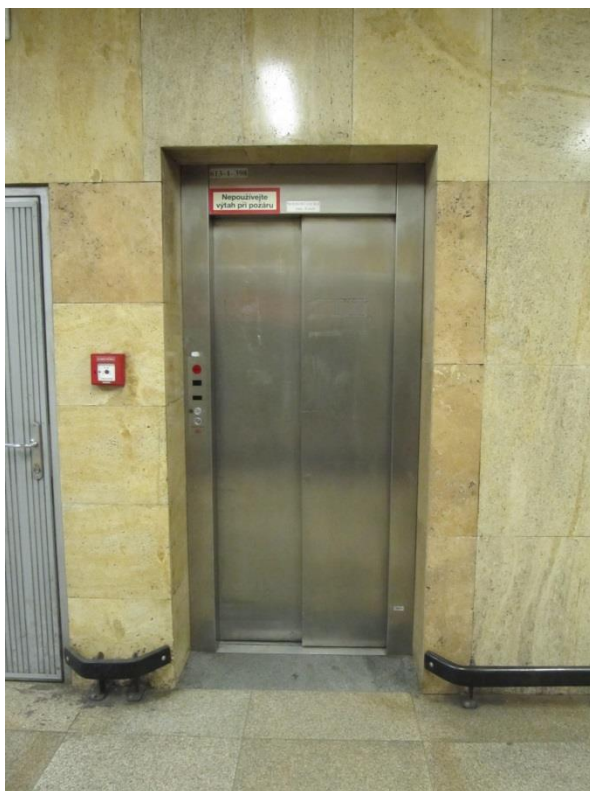
Obrázek 55 Osobní výtah č. 398 – stanice Budějovická
