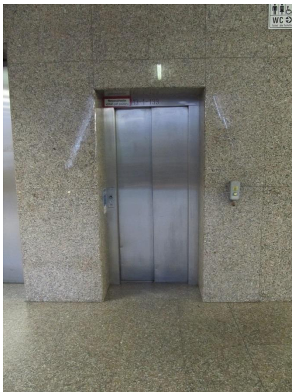
Obrázek 40 Osobní výtah č. 133 – stanice Vysočanská
