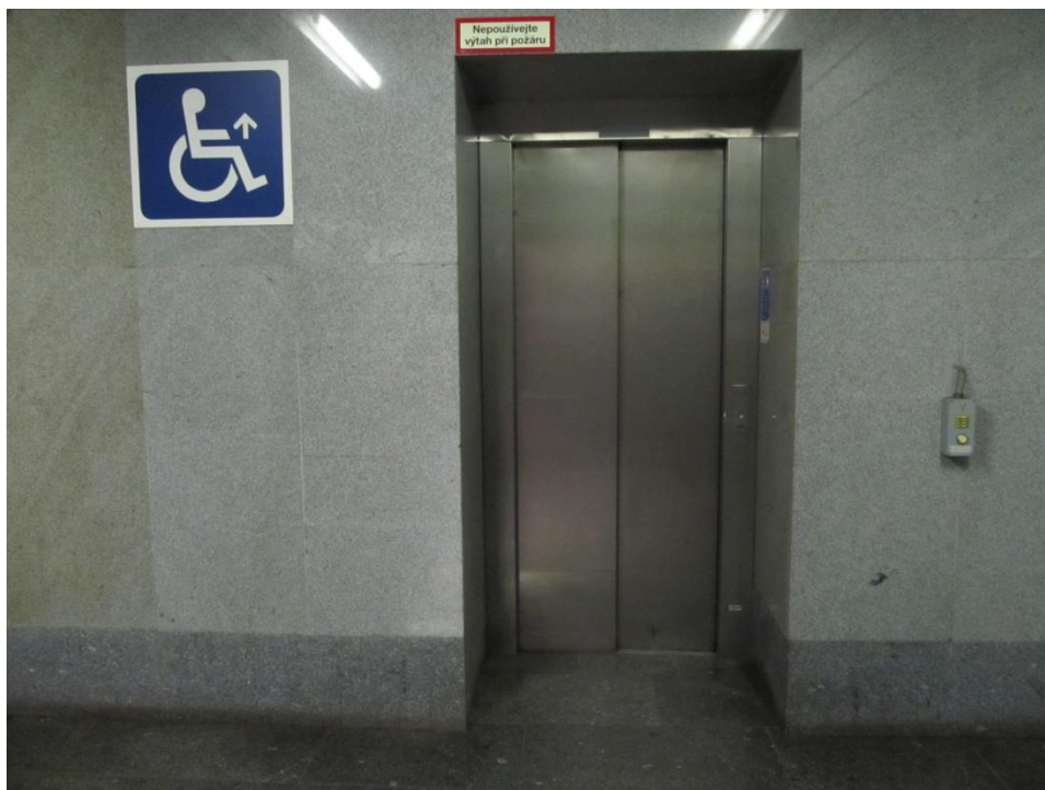
Obrázek 43 Osobní výtah č. 051 – stanice Kolbenova
