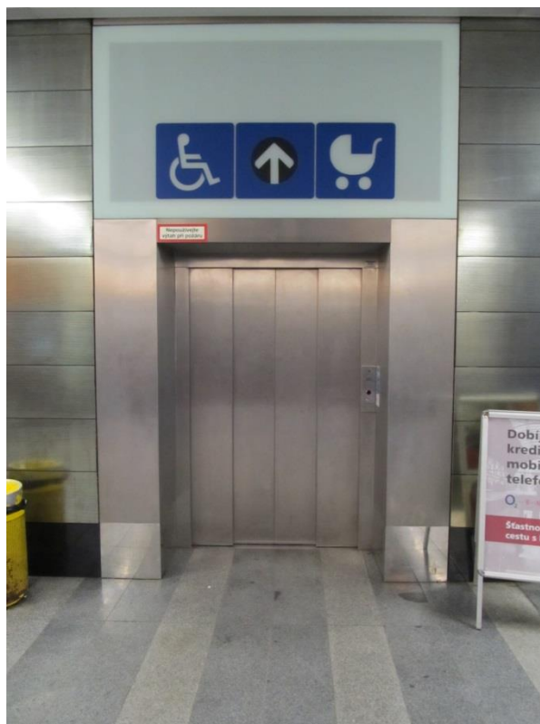
Obrázek 69 Osobní výtah č. 413 – stanice Střížkov
