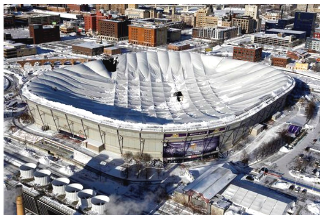
Obr. 2.5 Střecha stadionu po prolomení do inverzní polohy vlivem přetížení sněhem
