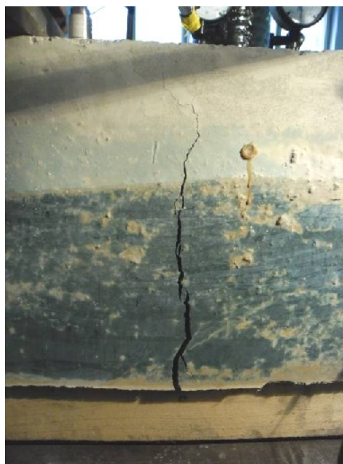
Obr. 116 – Trhlina – trám 4A+D
