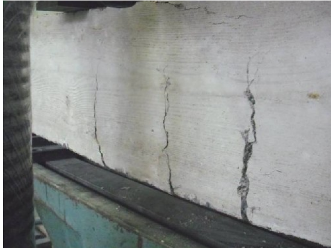
Obr. 117 – Trhliny – trám 5A+D+V
