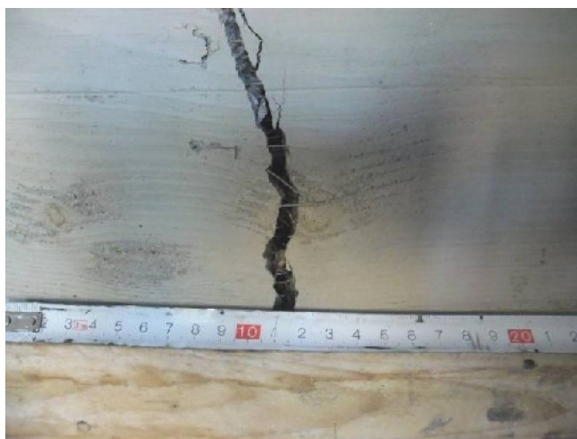
Obr. 115 – Detail trhliny – trám 2N+D
