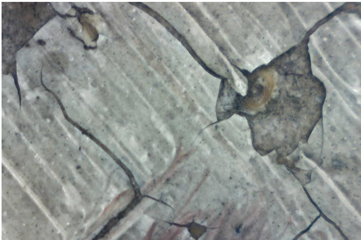
Obr. 59. Stav díla před restaurováním, detail krakeláže silné barevné vrstvy, 50x zvětšeno.
