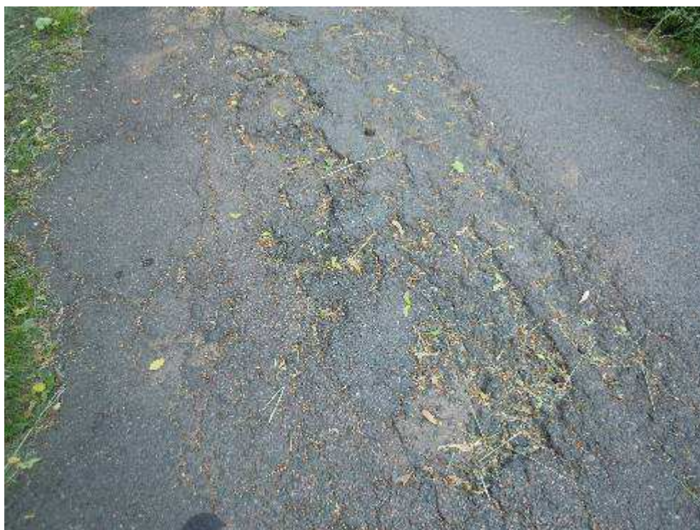
Obr. 3: Popraskaný asfalt na stezce (Autor)
