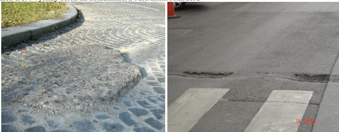
Obrázek č. 39: Vyteklý beton na komunikaci a odstranění retardéru
