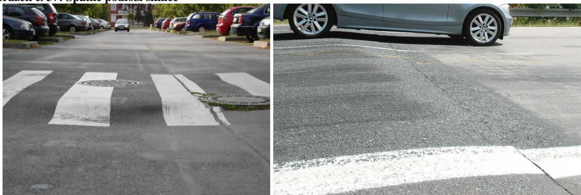
Obrázek č. 37: Špatné podloží silnice
