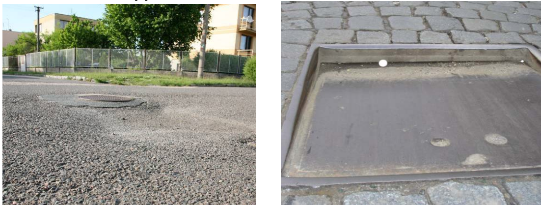
Obrázek č. 35: Neudržované kryty kanalizací
