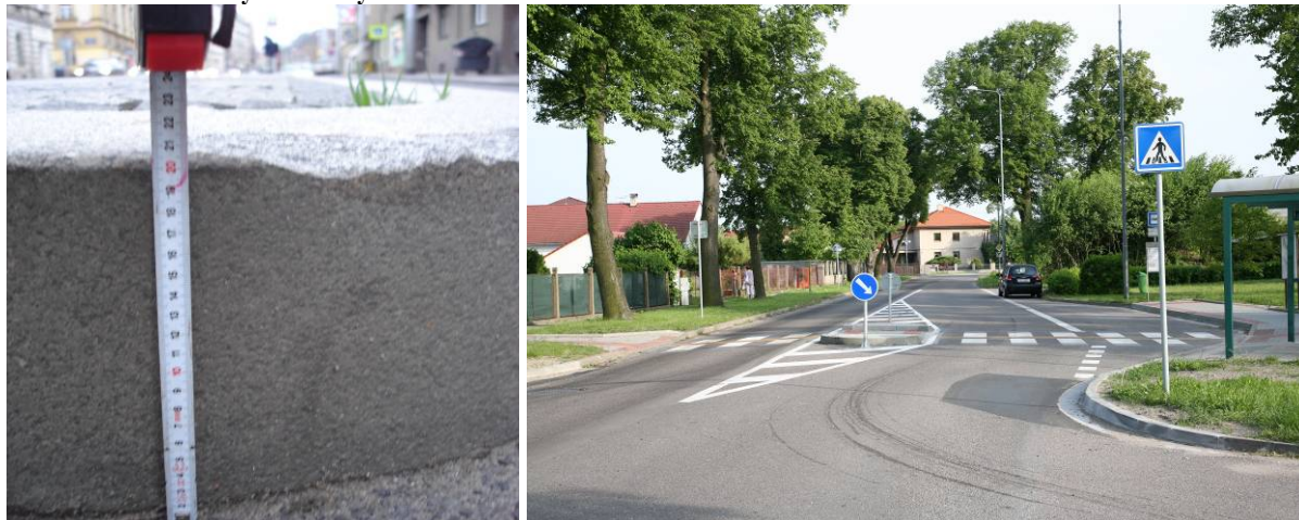
Obrázek č. 45: Ukázky nevhodných obrubníků
