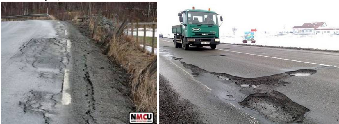
Obrázek č. 40: Špatný stav komunikací
