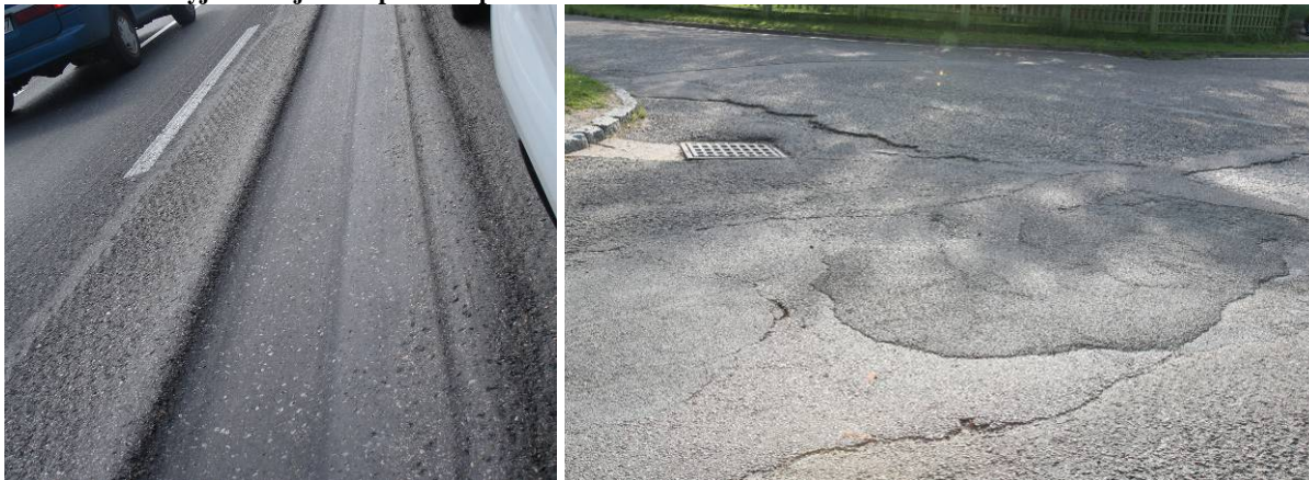
Obrázek č. 38: Vyjeté koleje a nesprávná oprava komunikací
