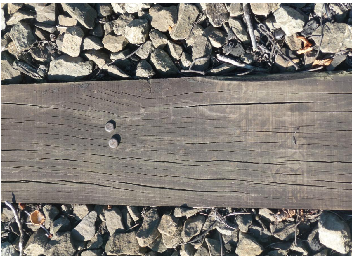
Obr.23 Detail pražce ve výhybce č. 7 z dubového nebo bukového dřeva, dle označení hřebů.
