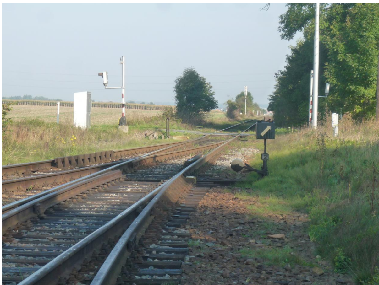
Obr.13 Pohled na výhybky č. 2 a 3, světelné signalizační zařízení pro přejezd silnice 3. třídy.
