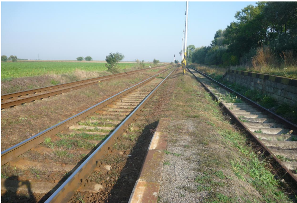
Obr.7 Pohled na všechny koleje ve stanici, konec nástupiště č. 1, vpravo neudržovaná rozpadající se boční rampa.
