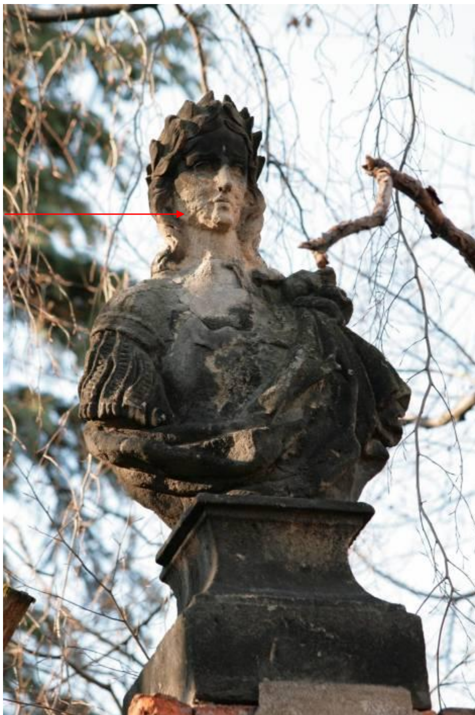
Obr. 50. Z heraldicky pravé iluzivní brány ústřední ženská busta, sochařská práce dílny Ignáce Rohrbacha? Kamenná busta je v havarijním stavu. Zvláště v oblasti krku a obličeje dochází k výraznému úbytku materiálu. Ostatní části pokrývá černá křusta. /foto Zdeněk Šmahel, 2010/
