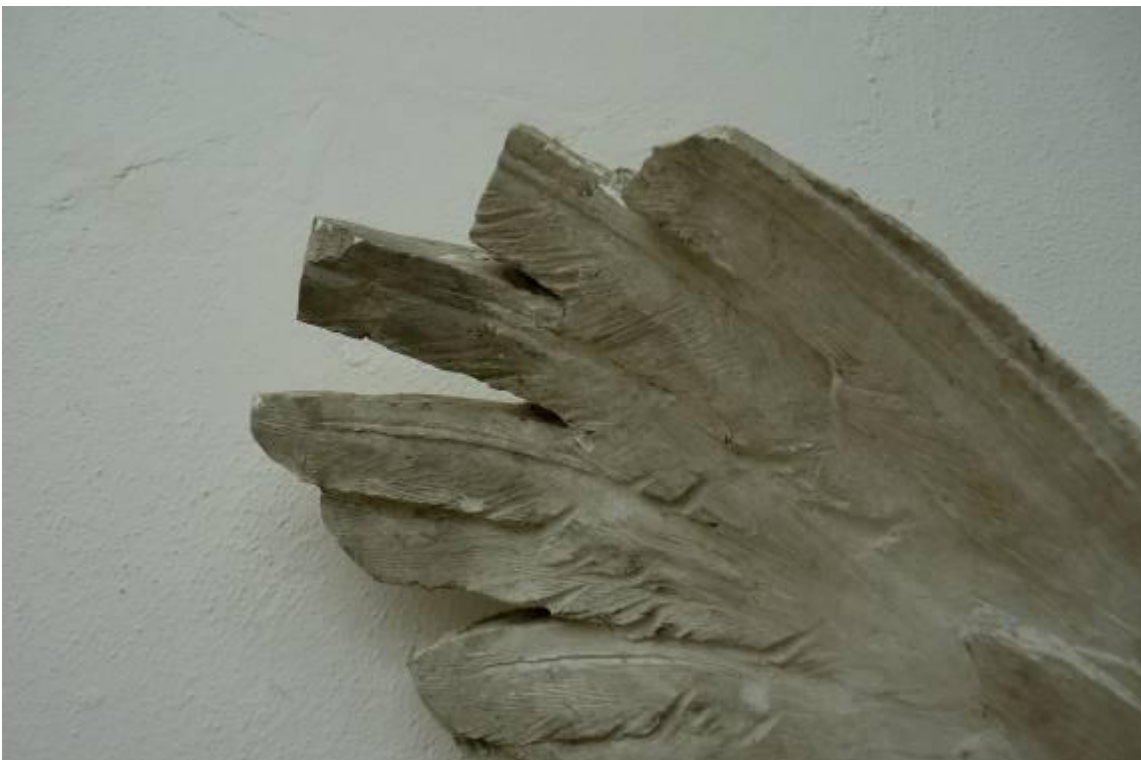
Obr. 20 stav před restaurováním – chybějící části zakončení per na pravém křídle
