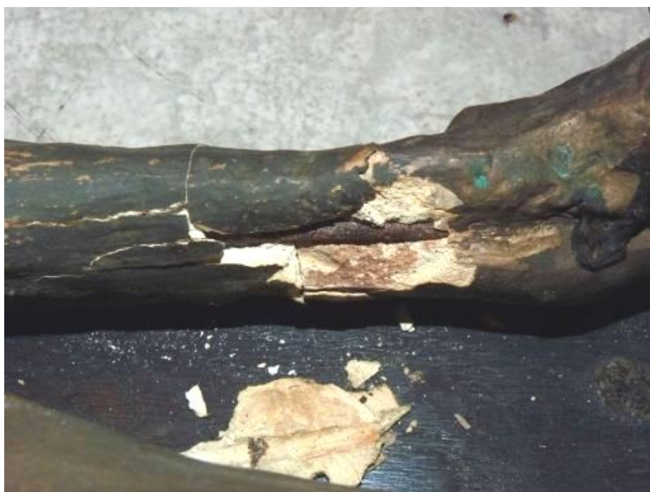
Obr. 113 detail poškození vlivem neošetřené korodující železné armatury
