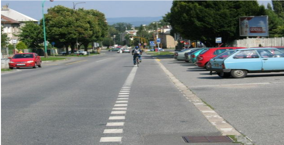
Obrázek 13 : Vyústění kanalizace umístěné v cyklopruhu
