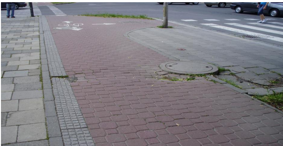
Obrázek 14: Propadlá zámková dlažba u vyústění kanalizace
