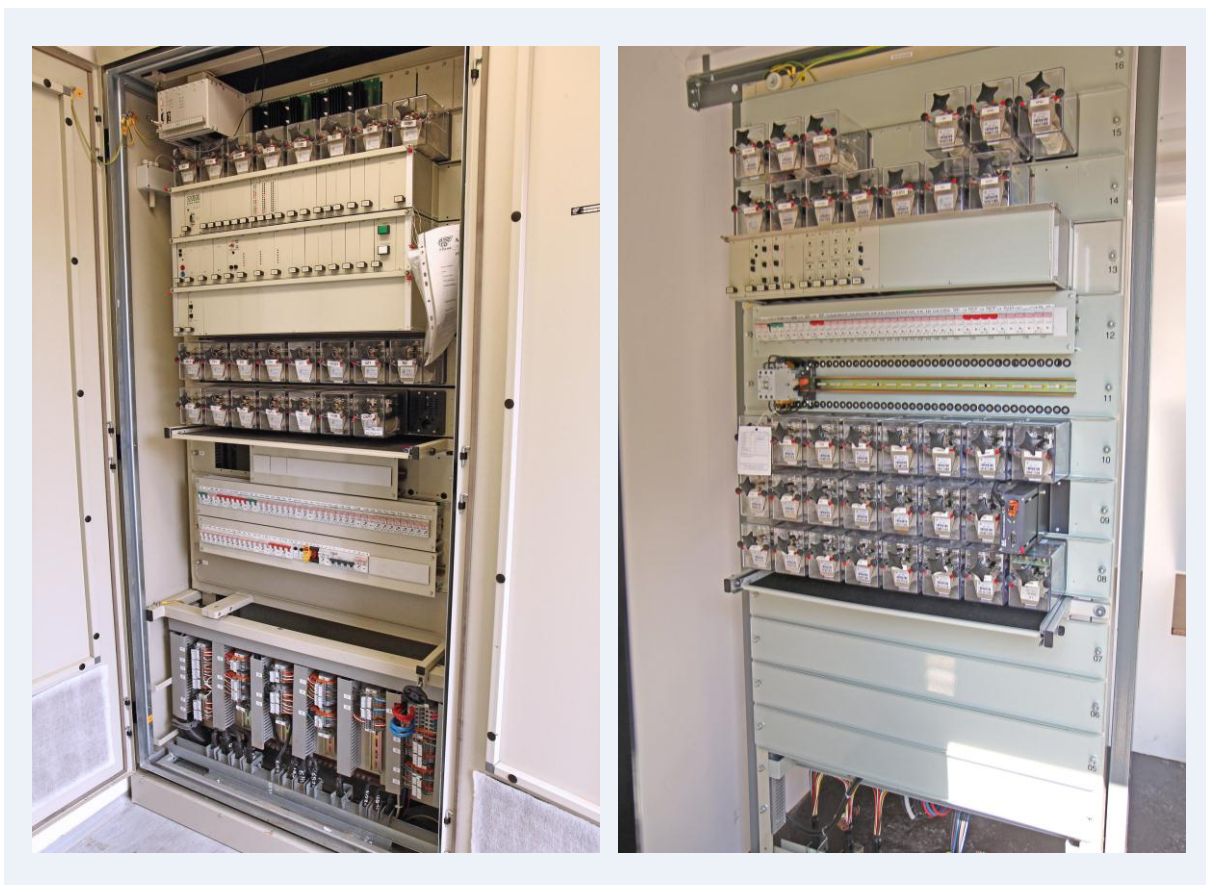
Obr. 3.27 Montáž vnitřní výstroje PZZ do skříně (vlevo) a do reléového stojanu (vpravo)
