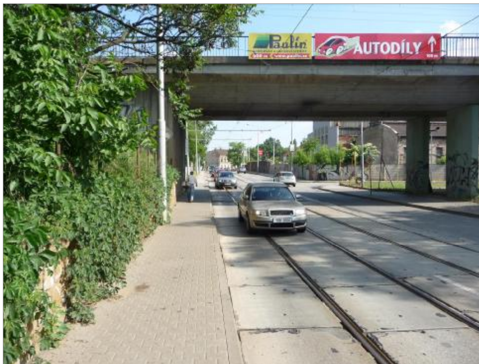
Obrázek 11: Tramvajová trať v ulici Dornych (nepříznivý stav) Zdroj: autor
