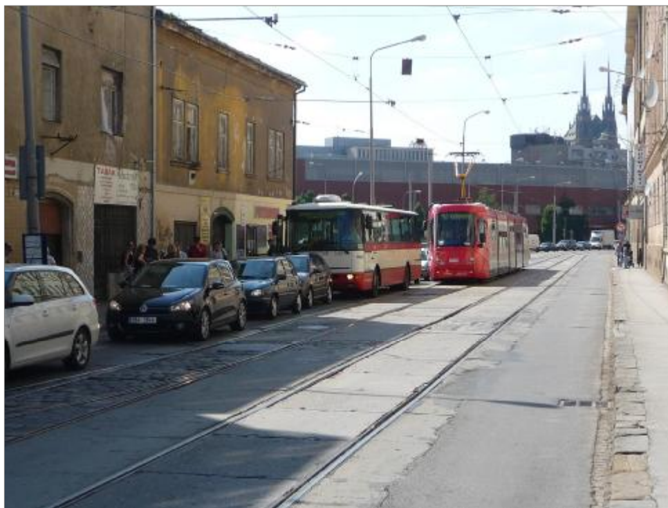
Obrázek 10: Tramvajová trať v ulici Dornych (nepříznivý stav)
