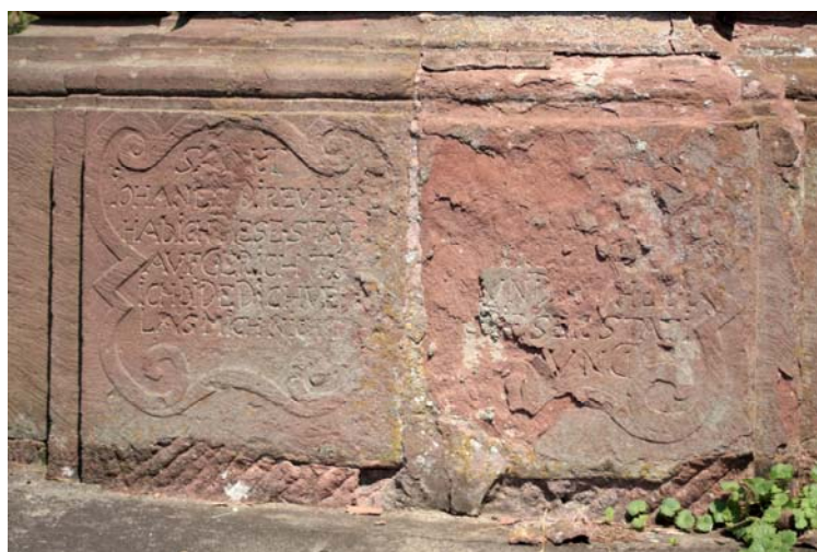
Foto č. 53. degradace povrchu v důsledku vzlínání vodorozpustných solí v kombinaci s vymýváním povrchu kyselými dešti, Čistá u Horek - sv. Jan Napomucký při čp. 179
