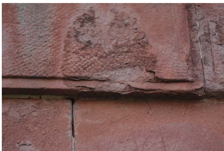
Foto č. 41. krustovatění povrchu, praskání a degradace materiálu pod krustou, Hostinné - ohradní zeď při galerii antického umění, Nádražní čp. 119
