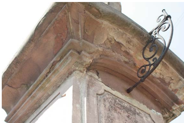
Foto č. 51. hromadění korozivních produktů v římsách, krustovatění a praskání po vrstvách, sloup Panny Marie – Libštát náměstí
