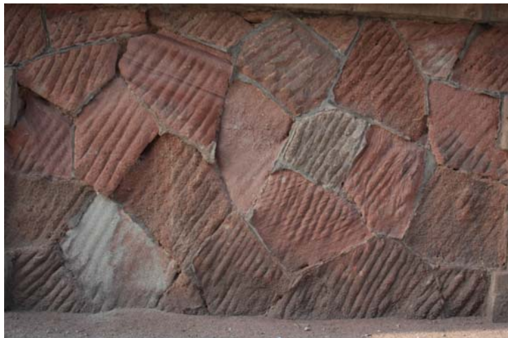
Foto č. 40. sokl domu v Hostinném – ul. Horská, čp. 130 – degradace v důsledku působení vodorozpustných solí a nesprávného uložení jednotlivých bloků
