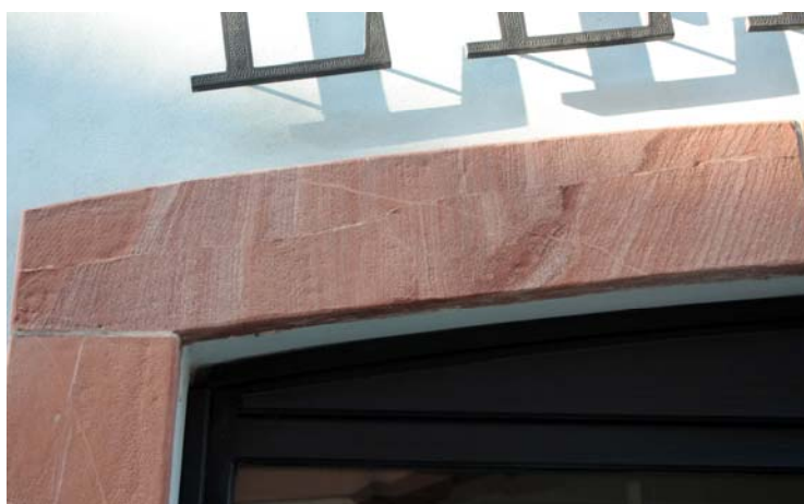
Foto č. 52. anomálie v kameni, v sedimentu došlo k prasknutí, poklesu a opětovnému stmelení ložiska, Hostinné čp. 41
