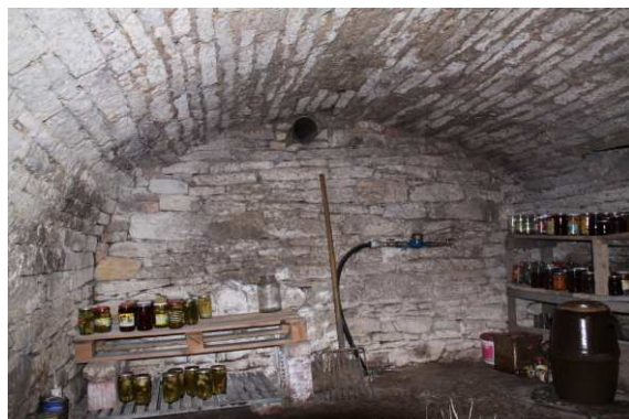
2) Pohled na čelní stěnu sklepa od vstupu se zachyceným tvarem valené klenby
