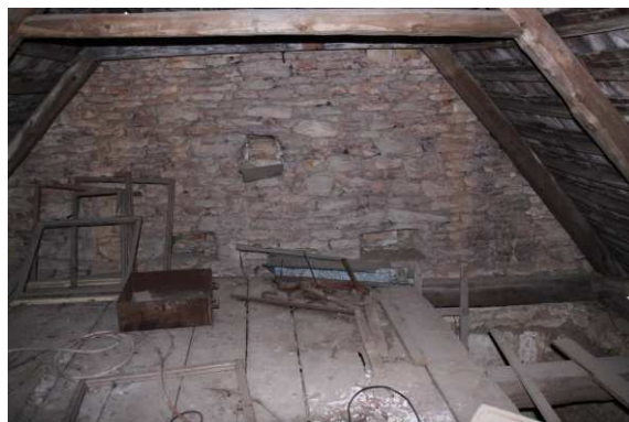
4) Opuka poškozená požárem na rubu čelního štítu
