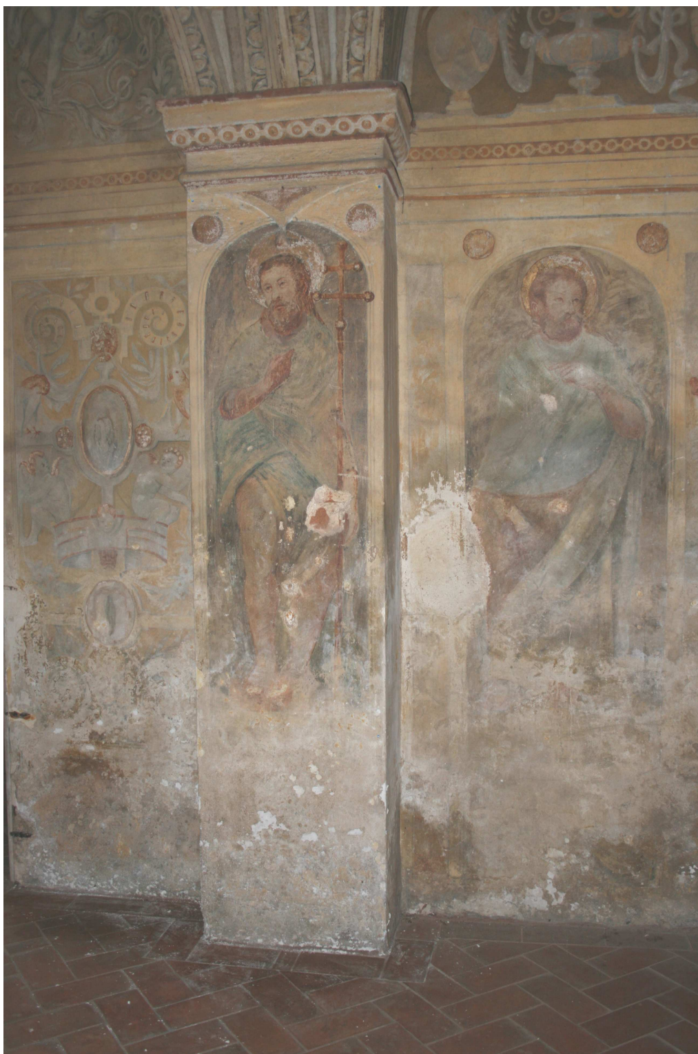
Obr. č. 4 Stav před restaurátorským zásahem – celkový pohled na restaurovanou část maleb
