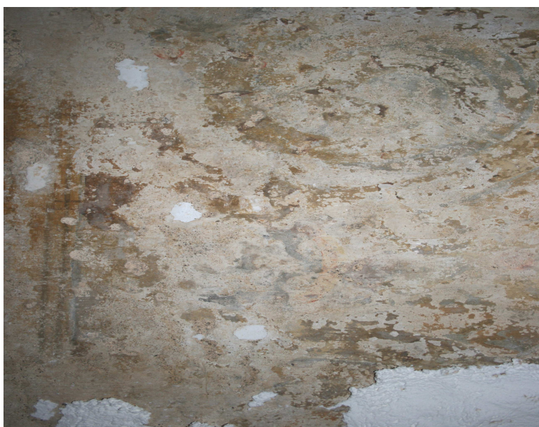
Obr. č. 10 Detail poškození barevné vrstvy
