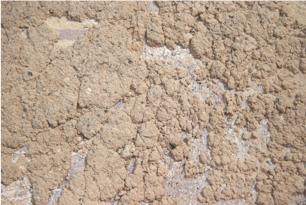
Obr. č. 4 Stav před restaurátorským zásahem – detail poškození zadní strany transferu
