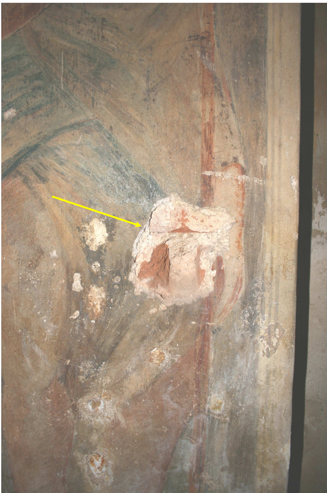
Obr. č. 5 Stav před restaurátorským zásahem – detail poškození barevné vrstvy → šipka ukazuje rozsáhlý defekt v omítkové vrstvě v postavě sv. Jakuba
