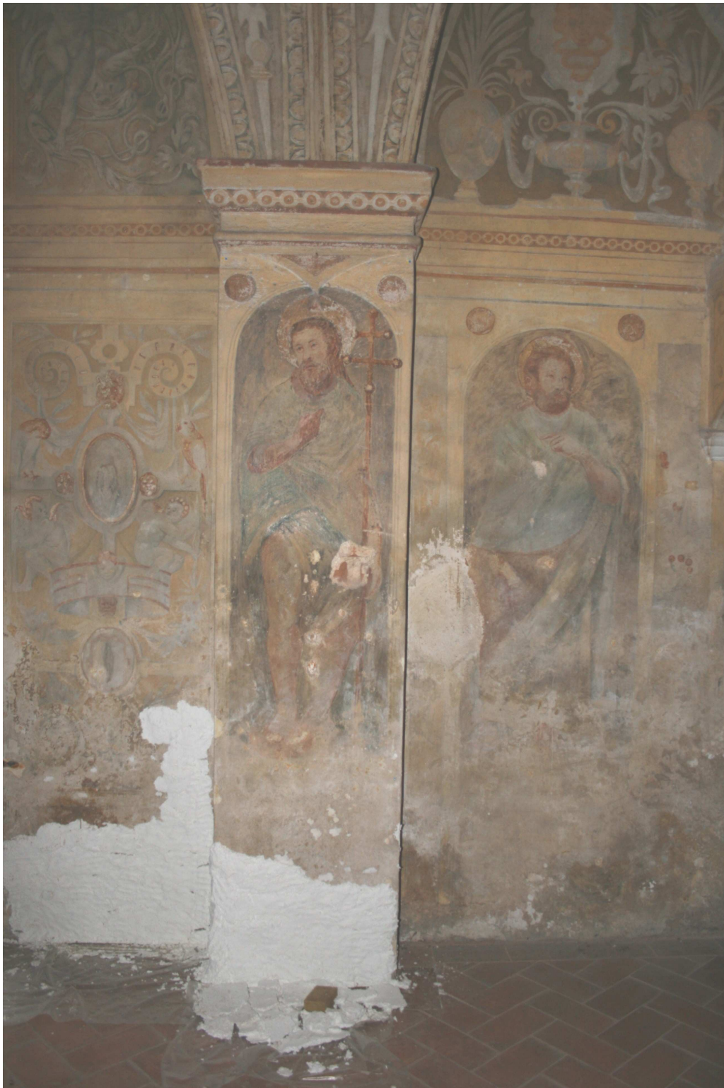
Obr. č. 22 Snímek ukazuje průběh odsolování omítkové vrstvy v dolní části
