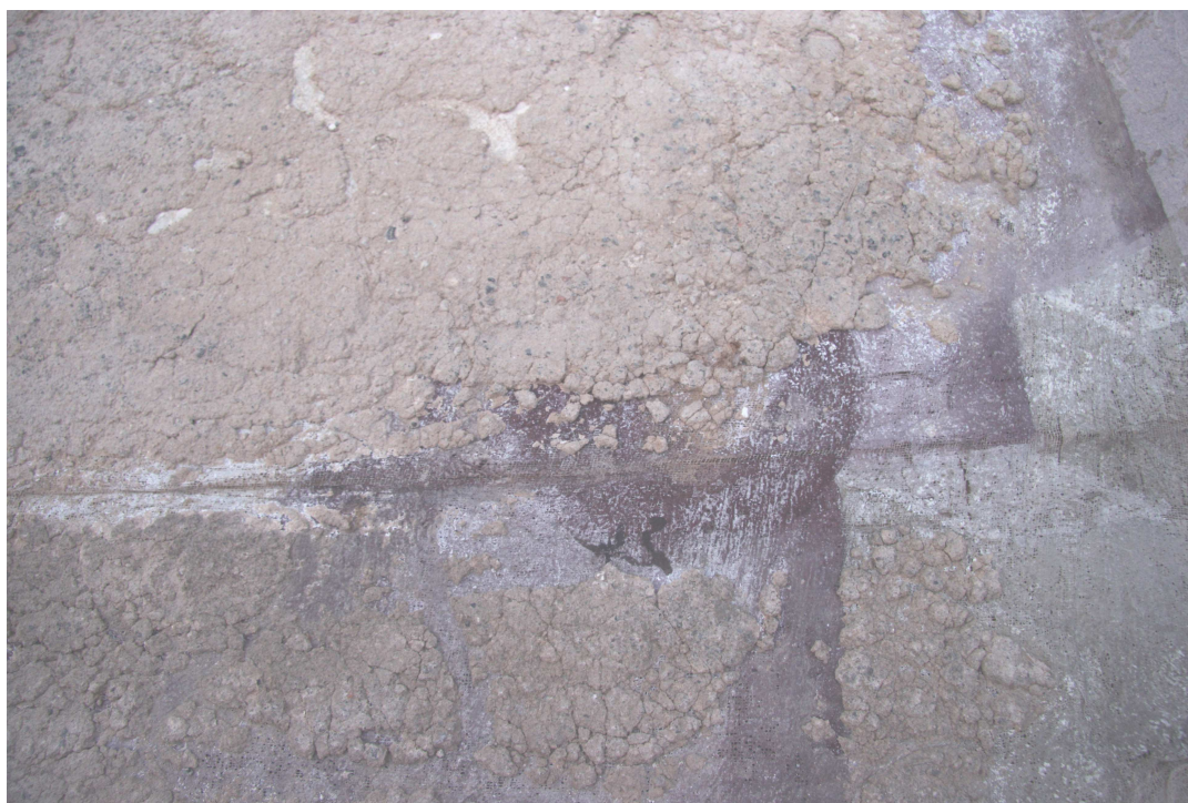
Obr. č. 3 Stav před restaurátorským zásahem – detail poškození omítky transferu z rubové strany
