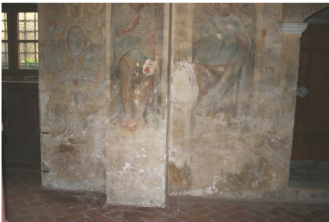
Obr. č. 9 Stav před restaurátorským zásahem, výrazné poškození maleb v dolní části
