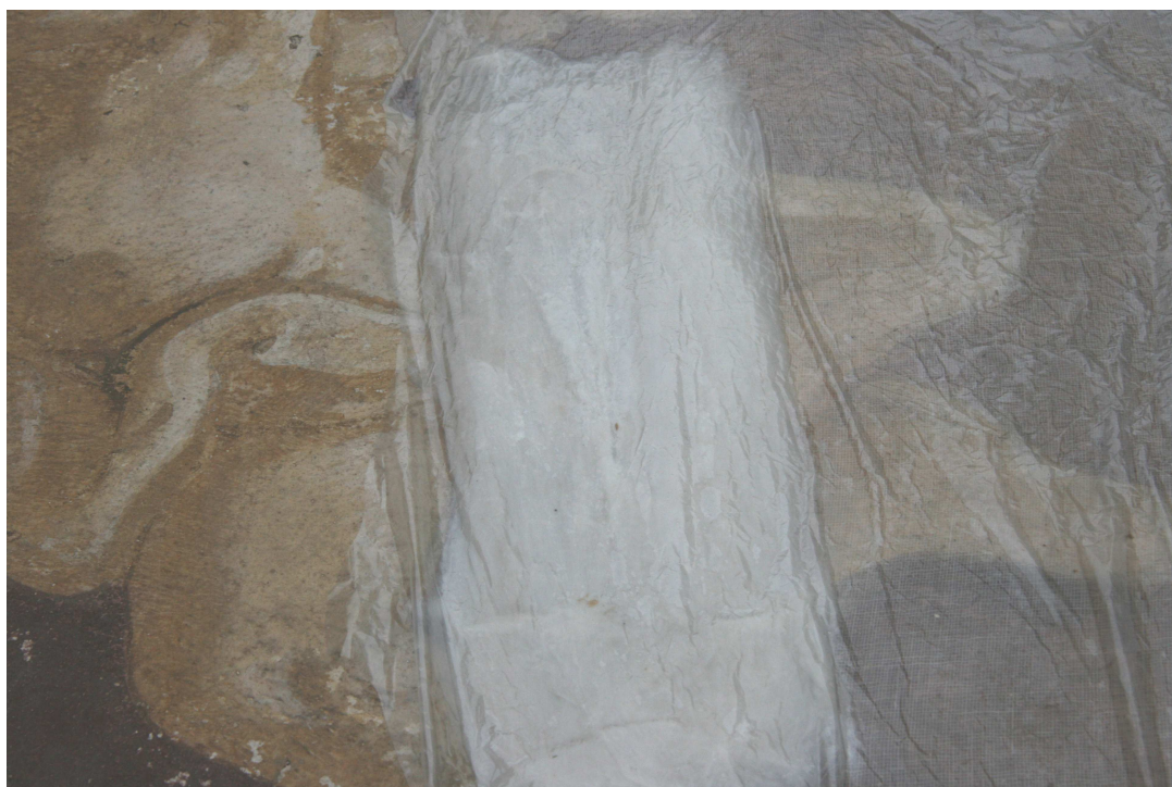
Obr. č. 13 Detail bandáže přelepu, která rozpustila lep přelepu, aby bylo možné sejmut textilní vrstvu z povrchu fresky
