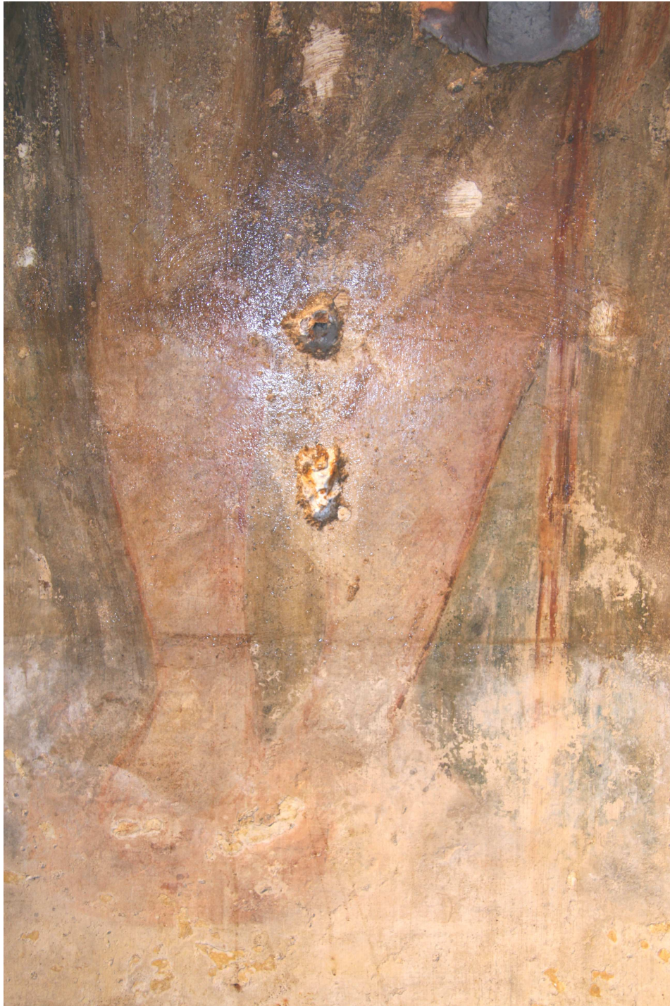
Obr. č. 14 Stav před restaurátorským zásahem – pohled v razantním světle ukazuje mechanické záseky do omítkové vrstvy a fixáž na povrchu barevné vrstvy
